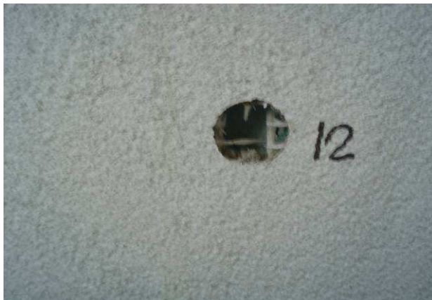
Fig. 9 – Sistema após ensaio de perfuração (zona em que não resistiu ao punção de 12 mm)
