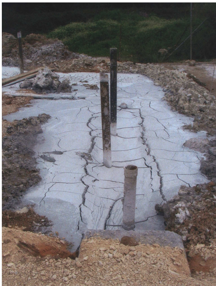
Foto 5 – Perda de verticalidade de um negativo instalado num painel do Alinhamento Nascente (PE35), a 26 de Fevereiro de 2002.
