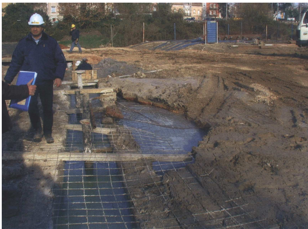
Foto 6 – Colapso do terreno confinante com o painel PE6, após a sua escavação (18 de Dezembro de 2001).
