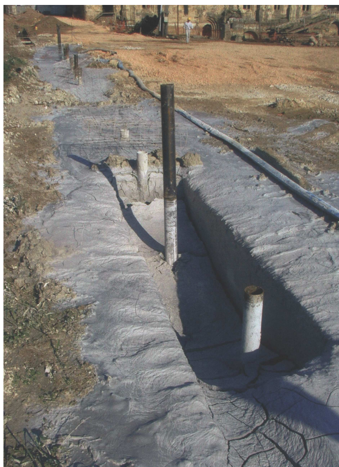
Foto 8 – Fendilhação por retracção de um painel de parede moldada auto-endurecedora. É também visível o rebaixamento da calda no interior do painel.
