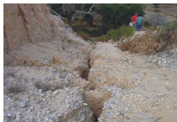
Fot. 6.10 - Barragem de Cadouços II. Pormenor de ravinamentos do rasto do canal descarregador de cheias. Fotografia tirada para jusante (COBA, 2001g).
