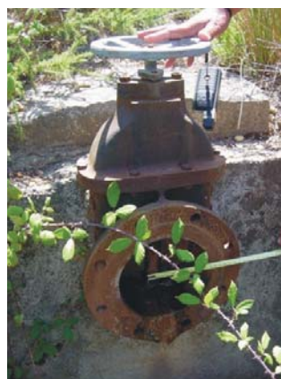
Fot. 4.26 - Barragem de Covões (CIGB). Válvula de cunha a jusante da conduta de tomada de água e descarga de fundo. Corrosão acentuada (ELU510) (COBA, 2001j).
