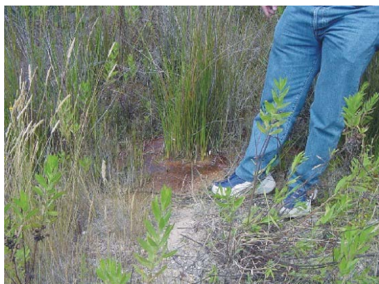
Fot. 4.3 - Barragem de Cadouços II (CIGB). Ressurgência com caudais moderados reconhecida no encontro direito, a jusante (ELUt 205) (COBA, 2001g).
