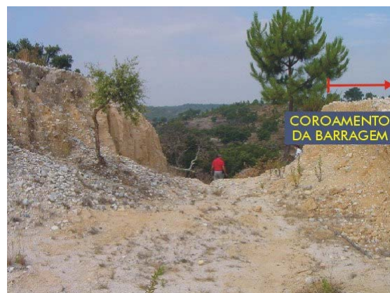
Fot. 4.46 - Barragem de Cadouços II (CIGB). Vista de pormenor da entrada do canal descarregador escavado no terreno natural. Reconhecida erosão superficial do rasto (ELU506) (COBA, 2001g).
