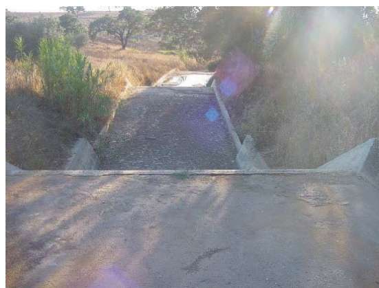
Fot. 4.42 - Barragem de Daroeira (CIGB). Vista do canal descarregador (sucessão de trechos em degrau). Fotografia tirada para jusante. Reconheceu-se erosão superficial do betão (ELUt506), fissuração e fendilhação do betão (ELUt507) e rotura parcial de lajes do rasto do canal (ELUt510) (COBA, 2001).
