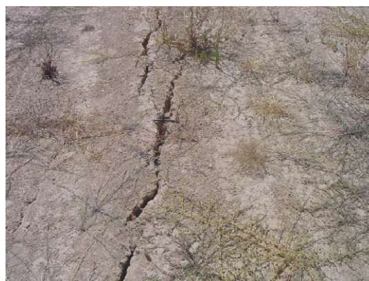
Fot. 4.12 - Barragem de Algalé II (RSB) . Pormenor de fenda longitudinal no coroamento que tem, nalguns trechos, abertura da ordem de grandeza do cm (ELU407) (COBA, 2001f).
