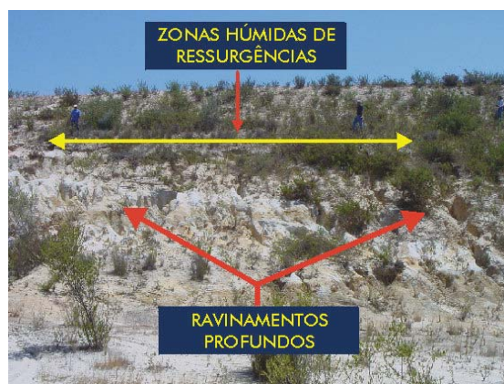
Fot. 4.23 - Barragem de Cadouços III (CIGB). Pormenor do paramento de jusante. Fotografia tirada para montante. Pormenor dos ravinamentos profundos no aterro (ELU406) (COBA, 2001h).
