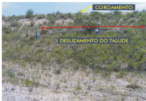
Fot. 6.11 - Barragem de Cadouços II. Cicatriz de um escorregamento com um rejeito de cerca de 0,8-1,0 m, no talude de jusante (margem direita) (COBA, 2001g).
