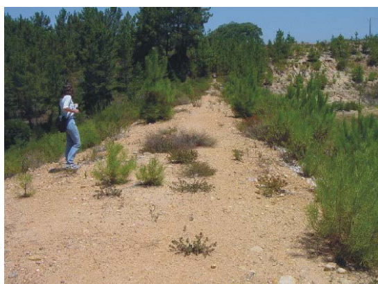
Fot. 4.9 - Barragem de Covões (CIGB). Vista do coroamento. Fotografia tirada para o encontro esquerdo. Reconhecidos assentamentos em trechos localizados (ELUt410), erosão externa superficial do aterro (ELUt408) e vegetação arbustiva e arbórea (ELUt411) (COBA, 2001j).
