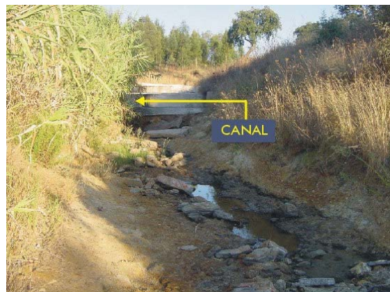
Fot. 4.44 - Barragem de Daroeira (CIGB). Vista do canal descarregador (trecho final). Fotografia tirada para montante. Rotura da secção do canal (ELU516) (COBA, 2001).
