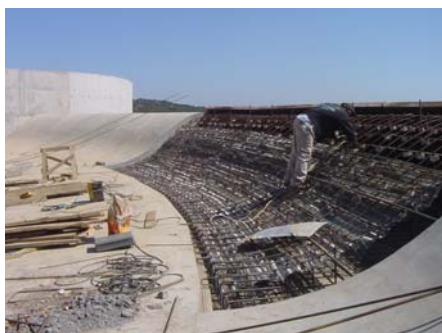
Vista geral da soleira do descarregador. Em curso a montagem de armaduras num dos tramos de betonagem.
