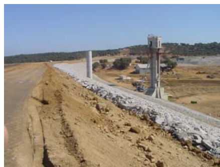
Vista dos aterros do maciço estabilizador de montante e do enrocamento de protecção. Visível a torre de tomada de água. Fotografia tirada para o encontro direito.
