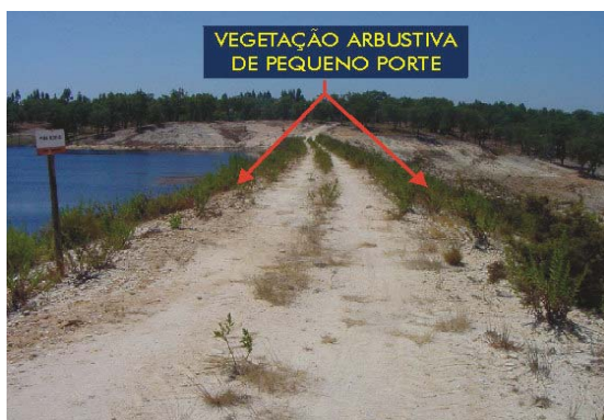
Fot. 6.14 - Barragem de Cadouços III. Vista geral do coroamento. Fotografia tirada para o encontro esquerdo (COBA, 2001h).
