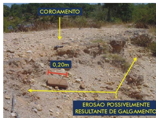
Fot. 4.15 - Barragem de Cadouços I (RSB). Pormenor do coroamento na zona onde se reconheceu um desnível importante relativamente à cota geral do coroamento (ELU408) e em que se identificaram erosões externas (no coroamento e talude de jusante), eventualmente resultantes de galgamento por reduzida altura de lâmina de água (ELU409) (COBA, 2001k).
