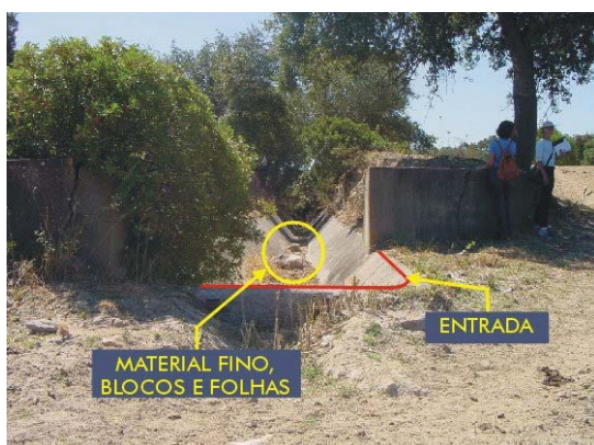
Fot. 4.36 - Barragem de Algalé I (RSB). Soleira do descarregador de cheias e trecho inicial do canal. Fotografia tirada para jusante. Reconheceu-se fissuração e fendilhação no rasto e nos muros do canal (ELUt507) e material sólido acumulado no interior do canal (ELUt501) (COBA, 2001o).
