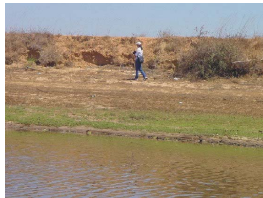
Fot. 6.33 - Barragem de Monte dos Alhos. Vista de pormenor do paramento de montante. Visíveis as erosões por acção da ondulação (COBA, 2001i).
