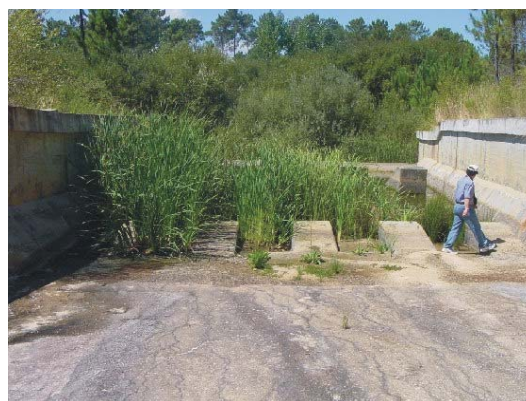
Fot. 4.40 - Barragem da Vale Cobrão (CIGB). Bacia de dissipação. Fotografia tirada para jusante. Reconheceu-se obstrução significativa da bacia de dissipação (e do canal de restituição) com material sólido acumulado e vegetação arbustiva (ELUt501) e erosão superficial dos dentes da bacia (ELUt506) (COBA, 2001c).
