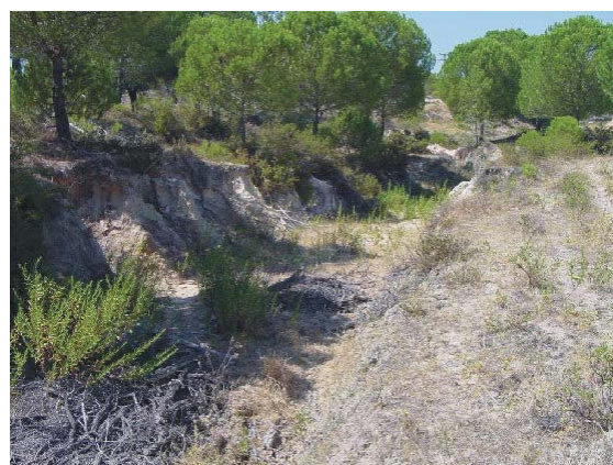
Fot. 4.51 - Barragem da Terça (RSB). Vista do canal descarregador, escavado no terreno natural. Fotografia tirada para montante. Reconhecidas erosões superficiais no rasto e nos taludes do canal escavado (ELUt506) (COBA, 2001n).
