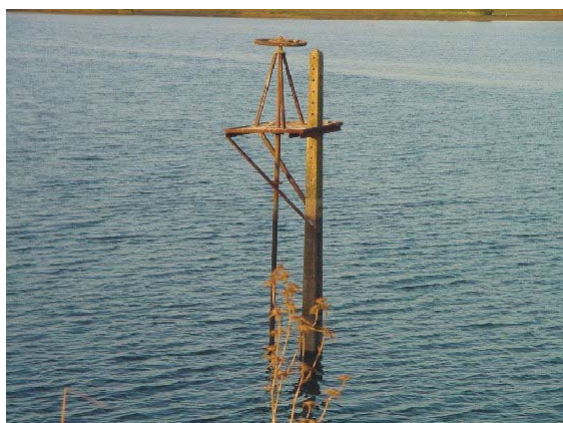
Fot. 4.25 - Barragem da Charnequinha (RSB). Haste e volante de manobra (apoiados em poste de iluminação) da comporta de montante da descarga de fundo e tomada de água. Operacionalidade condicionada (ELU511) por dificuldades de acessibilidade. Corrosão de todos os elementos metálicos e provável inoperacionalidade dos equipamentos (ELU515) (COBA, 2001m).
