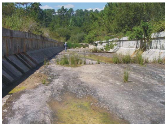
Fot. 4.39 - Barragem da Vale Cobrão (CIGB). Canal descarregador: trecho final a montante da bacia de dissipação. Fotografia tirada para jusante. Reconheceu-se fissuração e fendilhação no rasto e nos muros do canal (ELUt507), movimentos entre blocos com aberturas nas juntas importantes (ELUt508), percolação através de juntas (ELUt503) e vegetação em crescimento nas juntas do rasto do canal (ELUt501) (COBA, 2001c).
