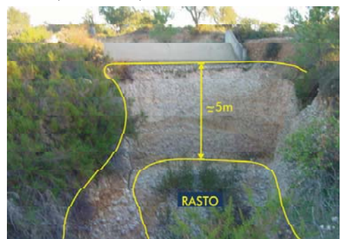
Fot. 6.31 - Barragem de Valeira Alta. Fossa de erosão à saída da estrutura descarregadora. Fotografia tirada para montante (COBA, 2001af).
