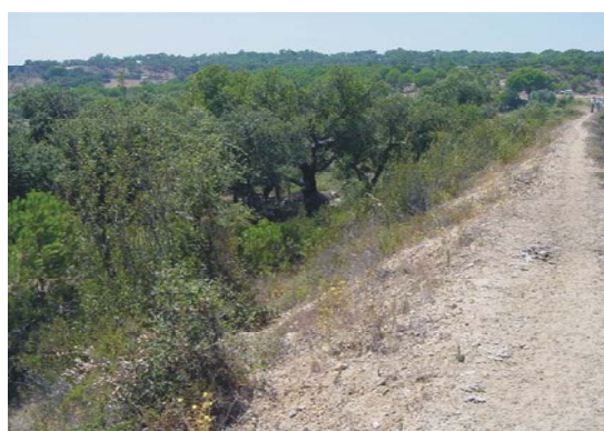
Fot. 6.2 - Barragem da Terça. Talude de jusante. Vista do coroamento para a margem direita. Visível vegetação arbustiva e arbórea de grande porte (COBA, 2001n).
