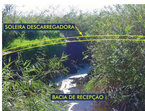
Fig. 6.22 - Barragem de Vale Sanceiro. Descarregador de cheias. Soleira. Visível a vegetação arbustiva densa no canal de aproximação e na bacia de recepção (COBA, 2001ac).
