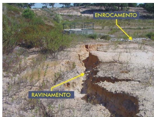
Fot. 4.4 - Barragem de Michões (CIGB). Vista do terreno a jusante da barragem. Fotografia tirada do encontro direito. Reconheceu-se erosão superficial dos terrenos a jusante da inserção do aterro na fundação (ELUt206) (COBA, 2001d).
