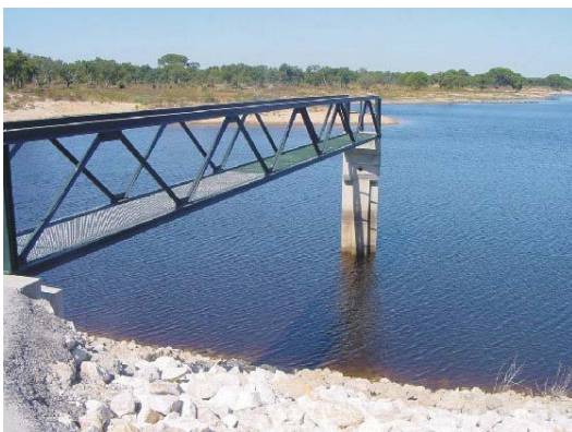
Fot. 4.34 - Barragem de Michões (CIGB). Vista da torre de tomada e passadiço de acesso à plataforma de manobras da comporta de tomada de água e descarga de fundo. Reconhecida deterioração do betão do pilar de guiamento (ELUt505) (COBA, 2001d).
