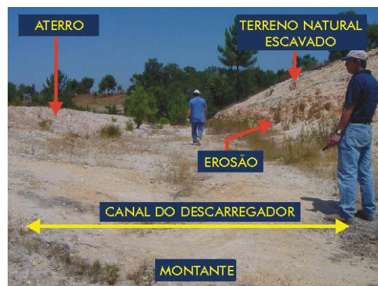
Fot. 4.49 - Barragem de Cadouços III (CIGB). Vista do canal descarregador de cheias, escavado no terreno natural. Fotografia tirada para jusante. Reconhecidas erosões superficiais no rasto e nos taludes do canal escavado (ELUt506) (COBA, 2001h).
