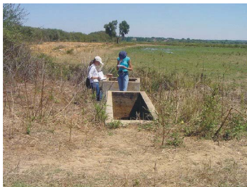
Fot. 6.34 - Barragem de Monte dos Alhos. Vista da câmara de manobras de jusante do sistema de descarga de fundo e tomada de água (COBA, 2001i).
