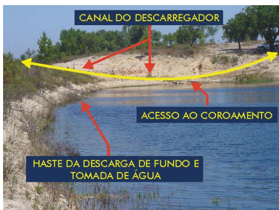
Fot. 4.48 - Barragem de Cadouços III (CIGB). Vista parcial do talude de montante e da entrada do descarregador de cheias, escavado no terreno natural. Fotografia tirada do paramento de montante para a margem direita. Reconhecidas erosões superficiais no rasto e nos taludes da secção de entrada do descarregador (ELUt506). O acesso ao coroamento atravessa a secção de entrada do descarregador, condicionando (em cheia) a acessibilidade ao coroamento e aos equipamentos de manobra da comporta de tomada de água e descarga de fundo (ELUt511) (COBA, 2001h).
