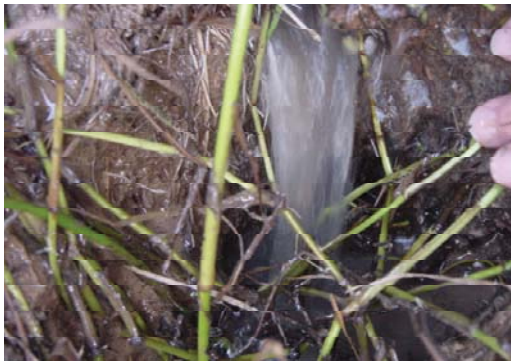
Fot. 6.7 - Barragem de Vale da Ursa. Caudal a jusante do principal ponto de emergência de água (COBA, 2001).
