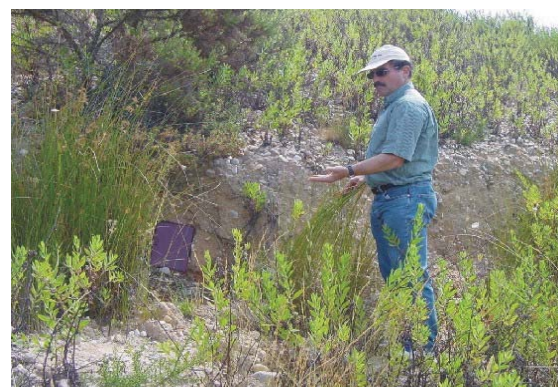
Fot. 6.12 - Barragem de Cadouços II. Pormenor da cicatriz do escorregamento ocorrido no talude de jusante (COBA, 2001g).
