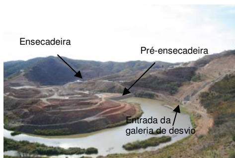
Fot. 7.1 – Vista do vale a montante da enseadeira de Odelouca (Fotografia da autora, em 09/09/2005).
