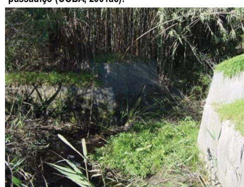
Fig. 6.23 - Barragem de Vale Sanceiro. Descarregador de cheias. Trecho inicial do canal. Obstrução por material fino e vegetação (COBA, 2001ac).
