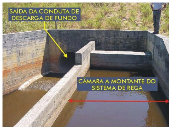
Fot. 4.33 - Barragem de Vale Cobrão (CIGB). Vista da saída da descarga de fundo (bacia de dissipação) e da tomada de água (câmara a montante do canal de rega). Reconhecidas deteriorações no betão (ELUt505) (COBA, 2001c).
