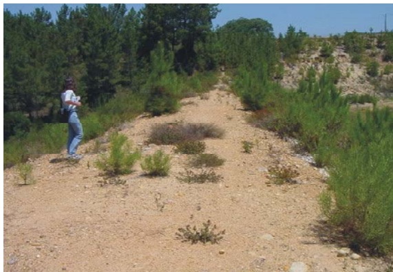
Fot. 6.16 - Barragem de Covões. Vista geral do coroamento. Reconhecidos desnivelamentos, fendilhação longitudinal e vegetação arbustiva. Fotografia tirada para o encontro direito (COBA, 2001j).
