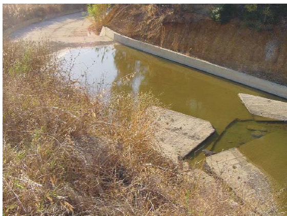
Fot. 4.43 - Barragem de Daroeira (CIGB). Vista do canal descarregador (trecho a montante de uma curva). Fotografia tirada para jusante. Rotura parcial de lajes do rasto do canal (ELU510) (COBA, 2001).
