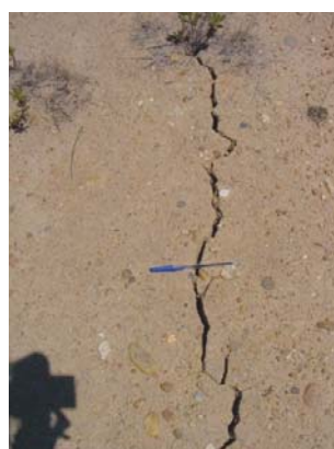
Fot. 4.10 - Barragem de Covões (CIGB). Pormenor de fenda longitudinal no coroamento que tem, nalguns trechos, abertura da ordem de grandeza do cm (ELUt407) (COBA, 2001j).
