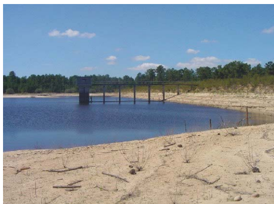
Fot. 4.32 - Barragem de Vale Cobrão (CIGB). Vista da torre de manobra do sistema de descarga de fundo e tomada de água, acessível por passadiço a partir do coroamento. A torre foi objecto de alteamento aquando do alteamento da barragem. Reconhecidas deteriorações no betão dos pilares do passadiço de acesso (ELUt505) (COBA, 2001c).
