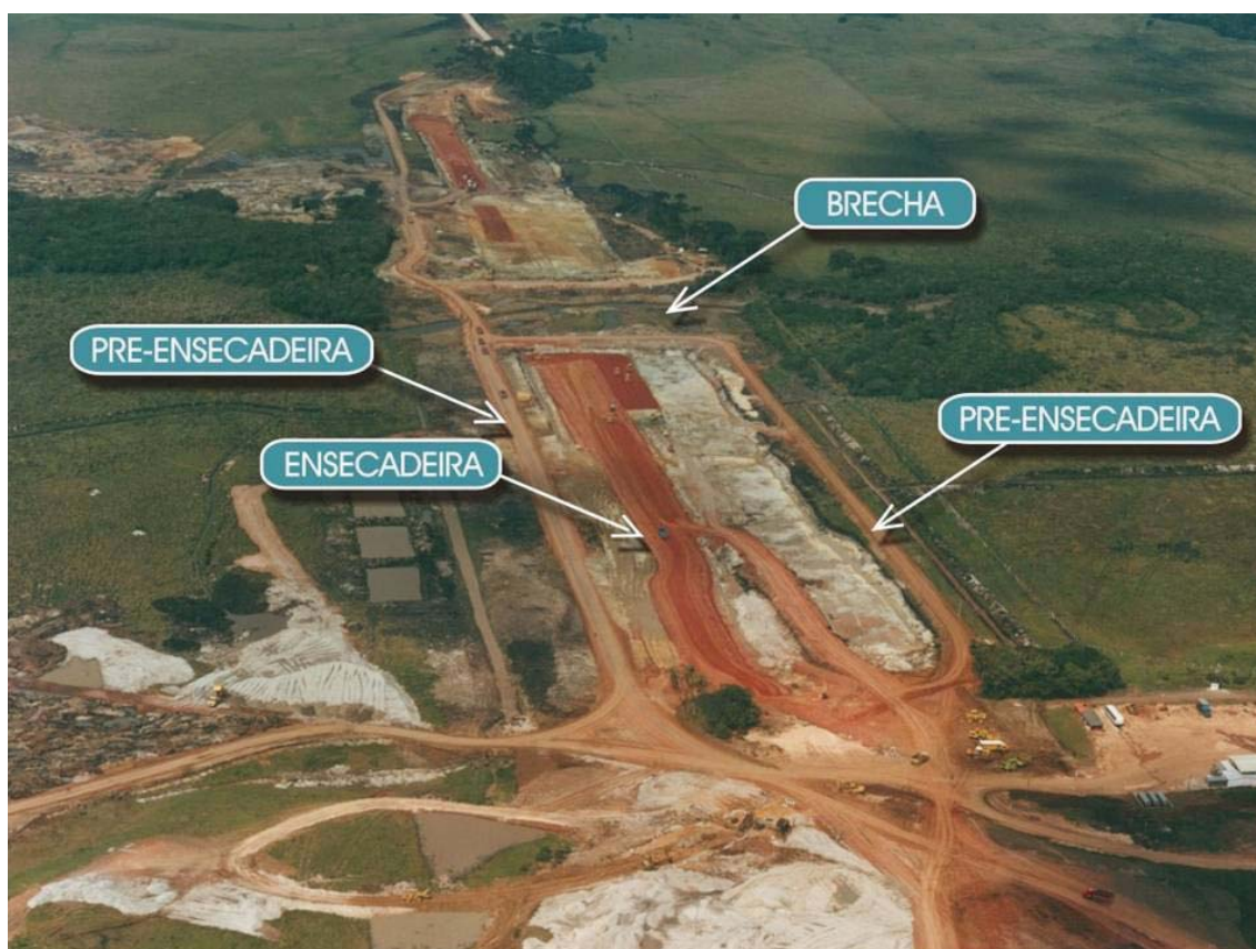
Fot. 7.14 – Barragem do Iraí. Vista geral dos aterros do corpo da barragem em construção (Vazquez, 2002).
