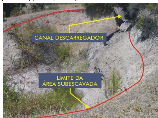
Fot. 4.37 - Barragem de Algalé I (RSB). Trecho final do canal descarregador e fossa de erosão a jusante. Fotografia tirada do encontro esquerdo. Rotura do trecho final do canal (ELUt516) (COBA, 2001o).
