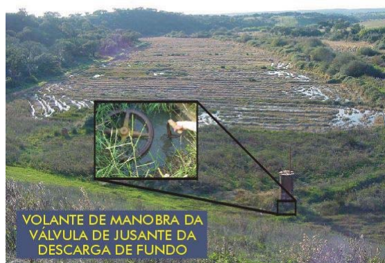
Fot. 4.31 - Barragem de Vale da Ursa (CIGB). Vista do local de manobras da válvula de tomada de água e descarga de fundo de jusante. Fotografia tirada do coroamento para jusante (visível o vale a jusante da barragem). Câmara inundada e operacionalidade condicionada (ELUt511) (COBA, 2001i).
