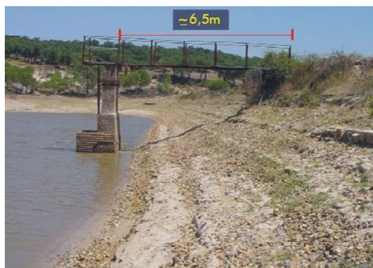
Fot. 6.4 - Barragem da Terça. Passadiço de acesso ao volante de manobra da comporta de tomada de água e descarga de fundo, em precárias condições de segurança (COBA, 2001n).
