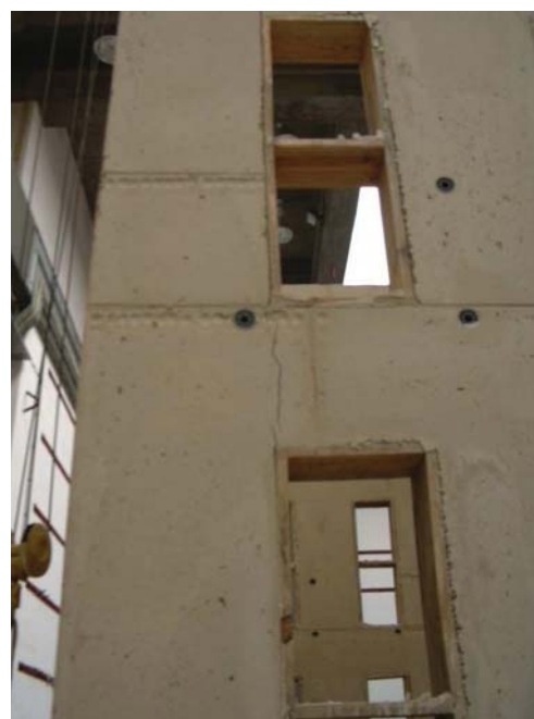
d) Abertura de fendas entre janelas
