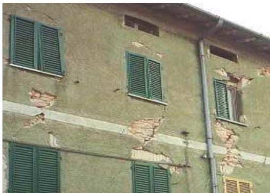
a) Rotura dos lintéis
