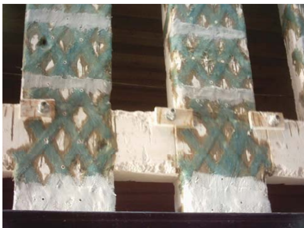
a) Vista das faixas de fibras de vidro coladas com resina epoxy
