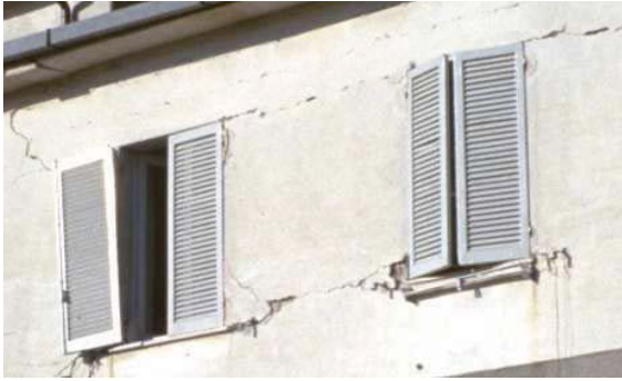
a) Rotura por flexão
