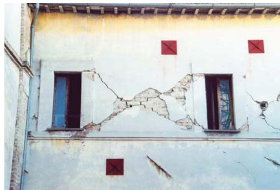
b) Rotura dos nembos
