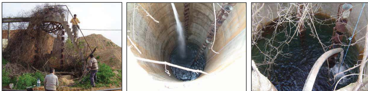
Figura 5.22 – Algumas fotografias do poço de grande diâmetro, onde foi realizado o ensaio de injeção, durante instalação do equipamento de monitorização, no início do ensaio e quando o nível piezométrico estabilizou muito próximo da superfície, no final do 3º ensaio (Lobo Ferreira et al., 2007b)
