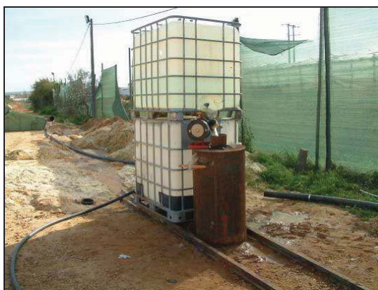
Figura 5.29 – Sistema de injecção utilizado para o furo de diâmetro intermédio (LNEC6) no Areal Gordo (Lobo Ferreira et al. , 2007b)
