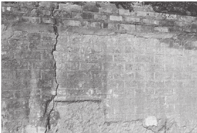
Fig. 5 – Reboco antigo com degradação superficial, mas muito são e coeso
