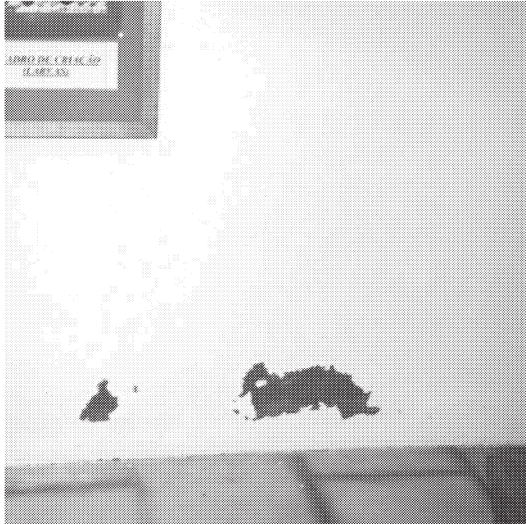
Fig. 13 – Argamassa de cimento em parede antiga. Patologia comum
