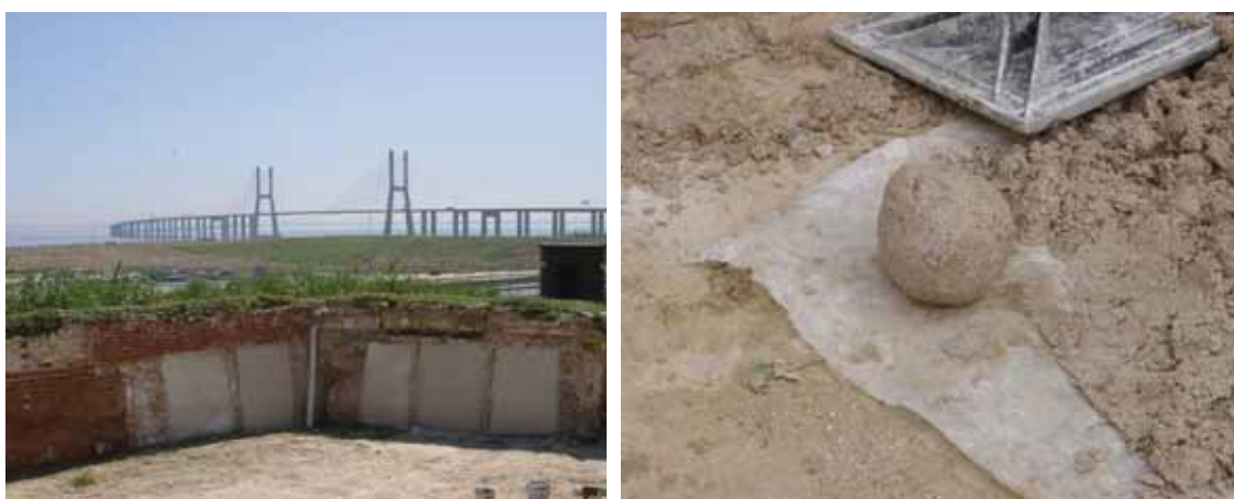
Fig. 45 – Estudo sobre a influência dos métodos de preparação e de aplicação de argamassas de cal: painéis experimentais e avaliação da consistência adequada
