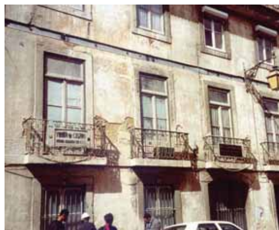
Fig. 21 – Degradação do acabamento em edifício Pombalino, acelerando a degradação das camadas interiores do revestimento
