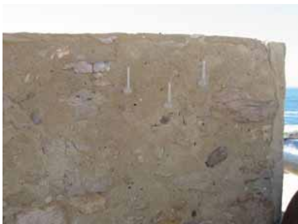
Fig. 41 – Revestimento com perda de coesão generalizada
