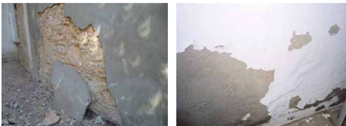
Fig. 43 – Revestimentos de cimento incompatíveis com as alvenarias antigas: rigidez excessiva e retenção de água na parede
