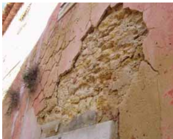
Fig. 42 – Revestimento com perda de aderência generalizada
