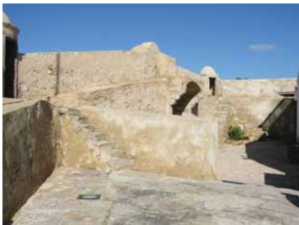
Fig. 33 – Degradação do reboco, com pulverização, por efeito do ataque salino da água do mar
