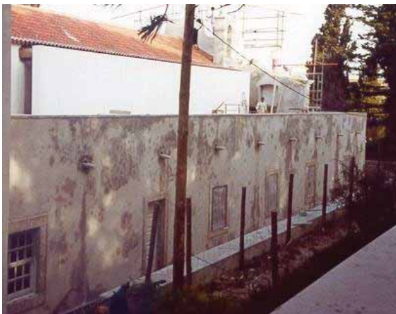
Fig. 5 – Reboco de cimento favorecendo a cristalização de sais higroscópicos no seu interior
