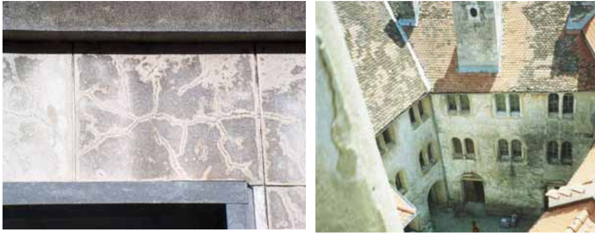
Fig. 7 – Degradação superficial: manchas, sujidade, fissuração a) no revestimento de marmorite do LNEC e b) em castelo esloveno (séc. XVI-XVIII)
