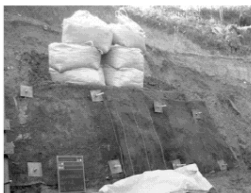
Figura 13 – Talude carregado com solo empacotado (Watanabe et al., 2006).
