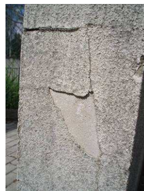
Fig. 7 – Destacamento do revestimento constituído por uma massa niveladora com um acabamento de tinta projectável aplicado sobre alvenaria em blocos de betão celular autoclavado
