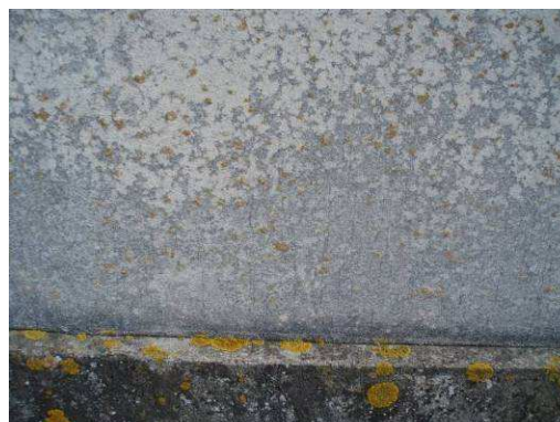
Fig. 9 – Presença de bolores e fungos em revestimento de isolamento térmico do tipo ETICS, aplicado em suporte de alvenaria de tijolo
