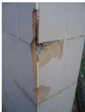
Fig. 6 – Revestimento cerâmico aplicado sobre alvenaria de tijolo parcialmente destruído no cunhal do murete e presença de fendilhação
