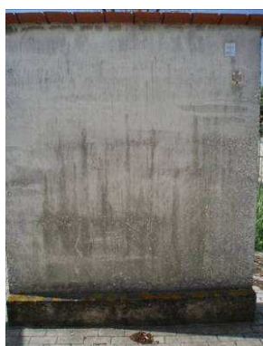
Fig. 10 – Manchas de humidade em revestimento de estuque sintético aplicado sobre alvenaria em blocos de betão celular autoclavado
