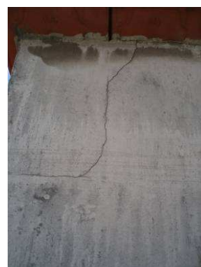
Fig. 11 – Fendilhação oblíqua em revestimento de estuque sintético aplicado sobre alvenaria em blocos de betão celular autoclavado
