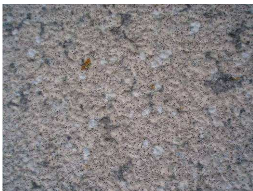
Fig. 8 – Presença de bolores, fungos e sais em revestimento de estuque sintético aplicado em alvenaria de blocos de betão celular autoclavado
