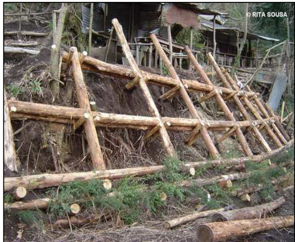
Figura 4.26 – Construção de uma grade viva sobre muro de suporte vivo, em Itália.
