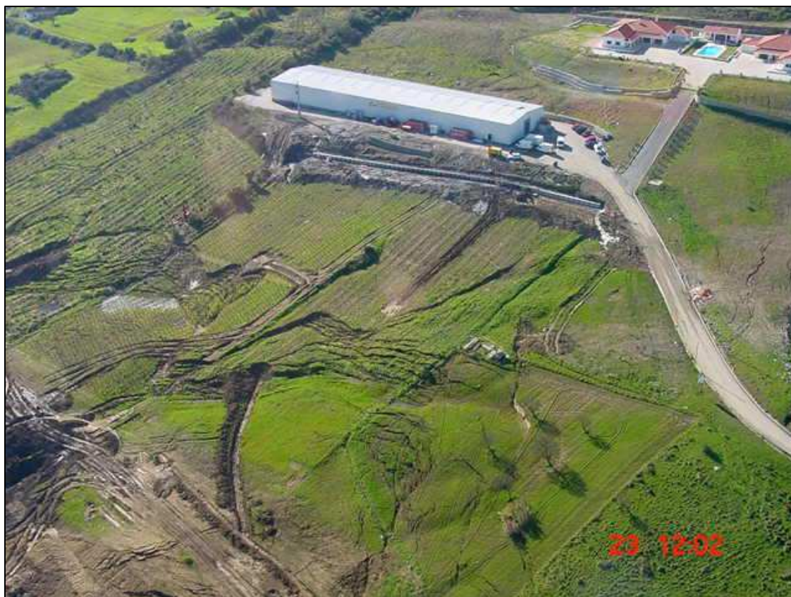
Figura 5.11 – Vista aérea da área instabilizada ao km 5+700.
