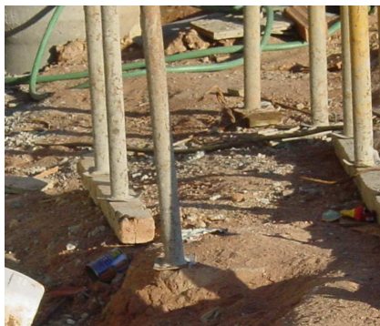
Figura 2.12 – Deficientes condições da fundação (1).
