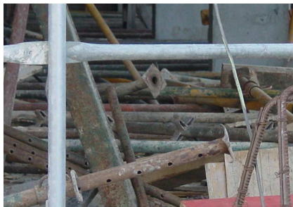
Figura 2.10 – Deficiente acondicionamento dos prumos.
