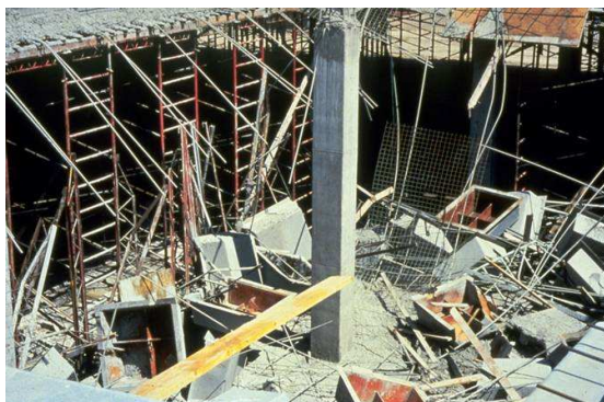
Figura 2.7 – Acidente num edifício.
