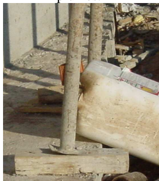
Figura 2.13 - Deficientes condições da fundação (2).
