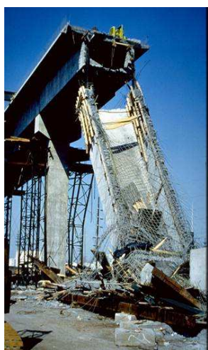
Figura 2.6 – Acidente numa ponte.
