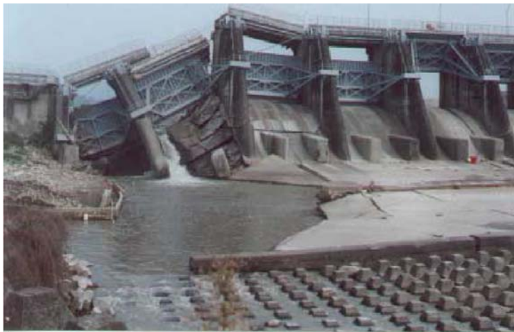
Fig. 3.18 – Barragem de Shih-Kang após o movimento de uma falha localizada na sua fundação durante o sismo Chi-Chi de 1990, pormenor da posição final do coroamento [Foster e Campbell, 2000]
