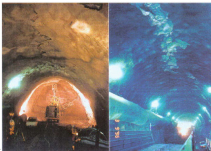
Figura 3.32 - Aspecto dos danos da abóbada nas margas de l'Aptien (André et al. , 1999)
