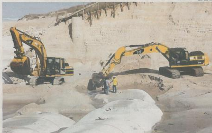
Obra da APA ainda está a decorrer mas a força das marés voltou a afectar o cordão dunar a Sul do 5.º molhe
