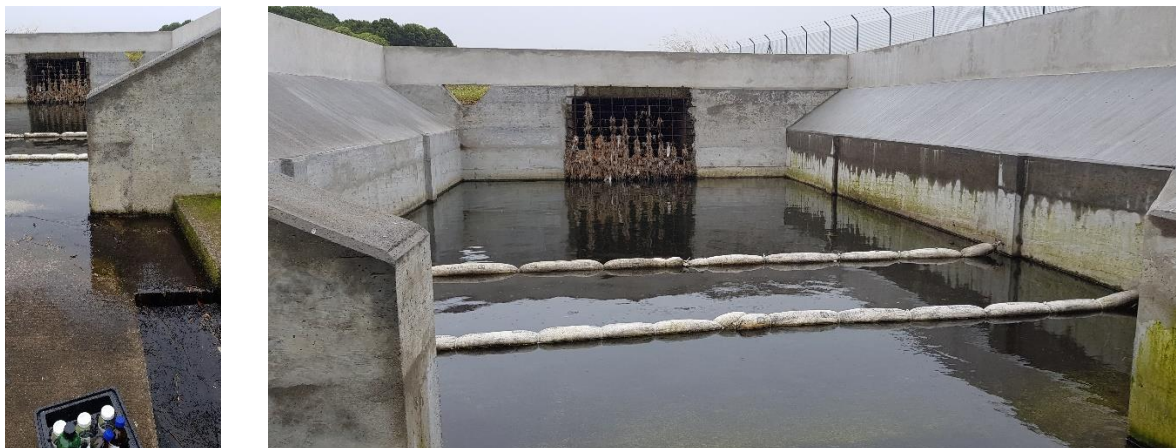
Figura 4.27 – Bacia de retenção das águas de drenagem superficial da pista de aviação das Lajes
