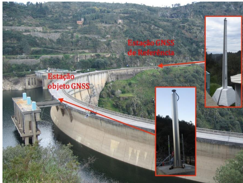
Figura 2. Localização das estações GNSS na barragem do Cabril: estação de referência, na margem esquerda, e estação objeto no coroamento da barragem.
