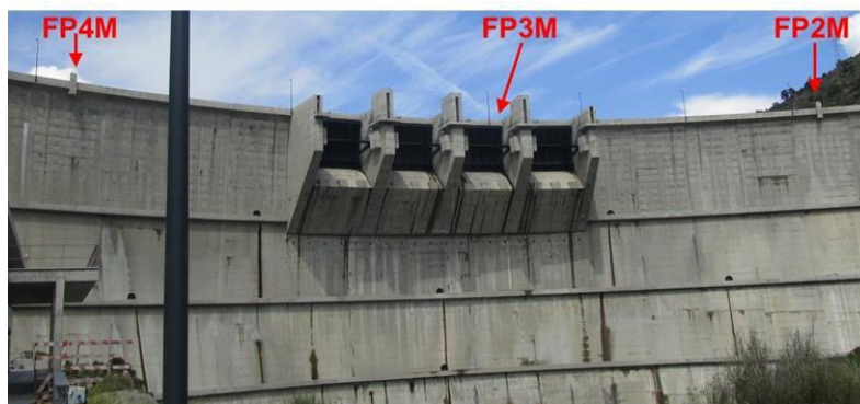
Figura 1. Localização das estações GNSS na barragem do Baixo Sabor: FP2M, FP3M e FP4M no coroamento da barragem.
