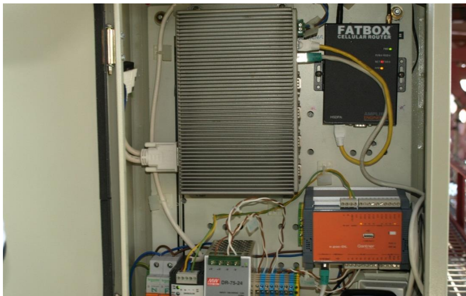
Fig. 6 – Módulo de controlo e computador
