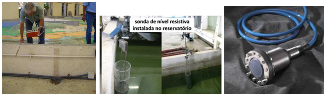
Figura 3.9 | Medição de níveis de água: a) piezómetro de coluna de água; b) sonda resistiva; c) sonda acústica
