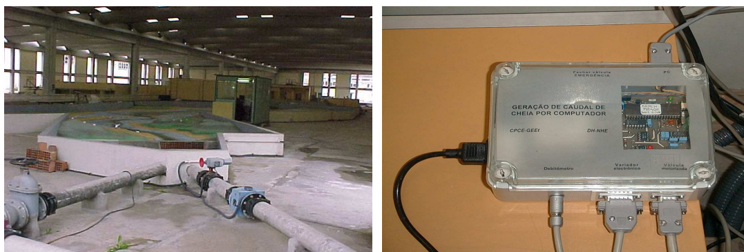
Figura 3.14 | Sistema de controlo de caudais para realização de ensaios em regime variável: a) aspeto da válvula motorizada e do debitómetro ; b) aspeto do exterior da unidade digital de interface (Fonte: Viseu, 2006)
