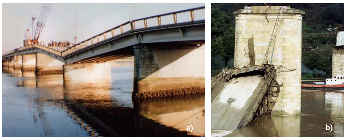
Figura 3.6 | Acidentes em pilares de pontes: a) Ponte Cale da Vila, Gafanha da Nazaré, 1994; b) Ponte Hintze Ribeiro, Entre-os-Rios, 2001
