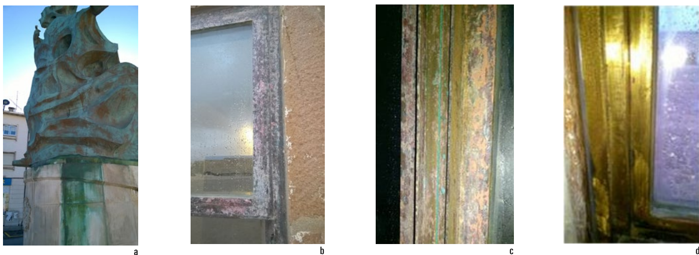
Figura 15 Morfologia e aspeto típico das pátinas do cobre e ligas (em cima). Exemplos de formas de corrosão ativa em ligas de cobre: a. Dissolução de pátinas; b. Deszincificação em caixilharia de latão; c. Detalhe do lado exterior; d. Detalhe do lado interior. Fotografias da autora.
