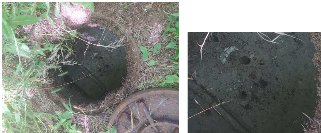
Figura 2.5 – Câmara de visita a jusante (CV 2) com uma altura significativa de depósitos relativamente secos
