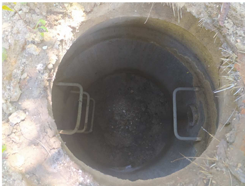
Figura 2.6 – Câmara de visita mais a jusante (CV 4), junto ao edifício do Departamento de Transportes, onde já não se observa a acumulação de sedimentos de reduzida dimensão
