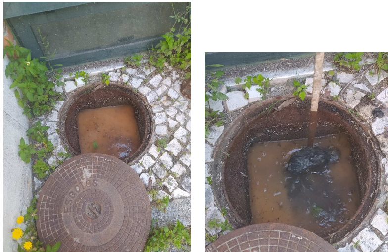
Figura 2.4 – Localização e pormenor dos sedimentos da câmara de visita à saída da sala de corte do DBB (CV 1)
