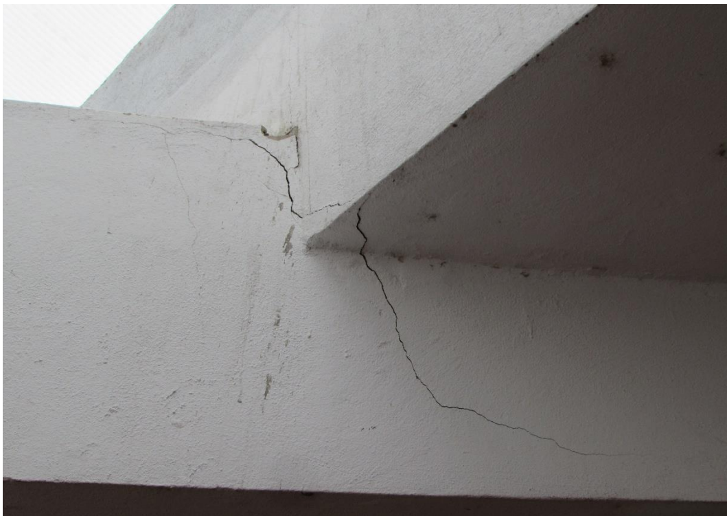
Fotografia 34 – Pavilhão desportivo: danos numa viga do hall do pavilhão
