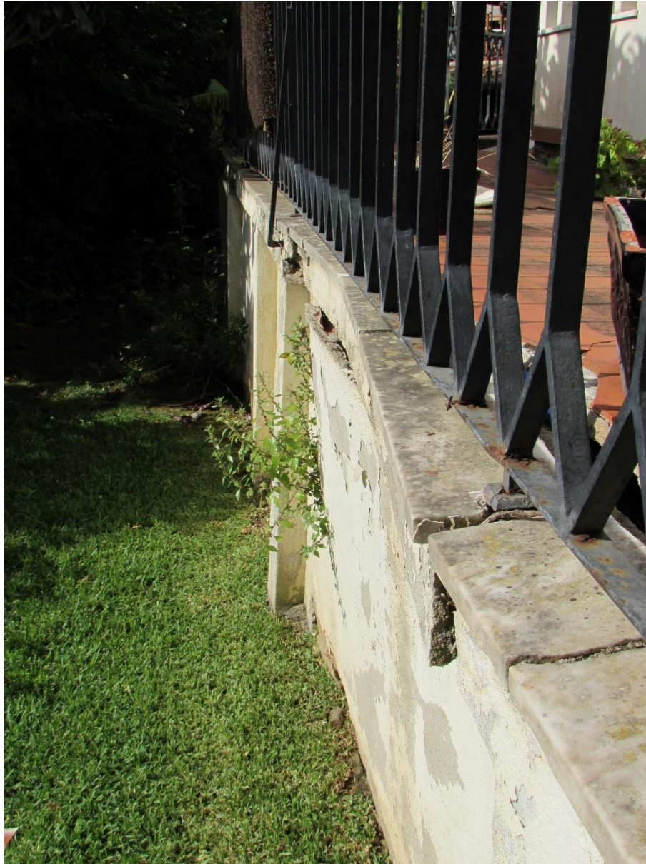
Fotografia 12 – Danificação na parede do terraço causada por assentamentos diferenciais
