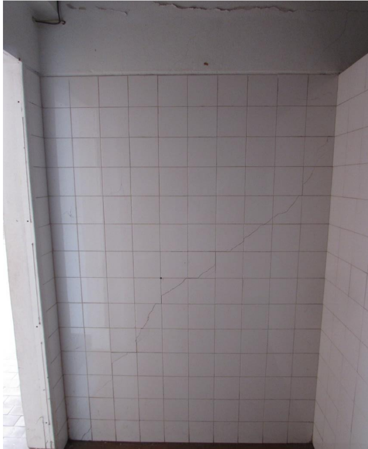
Fotografia 33 – Pavilhão desportivo: danos nas alvenarias em parede de balneário por assentamentos diferenciais
