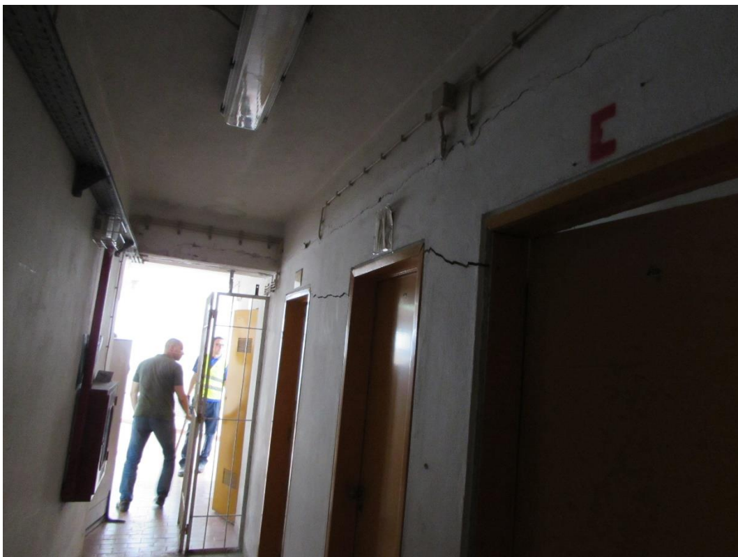
Fotografia 36 – Pavilhão desportivo: danos em alvenaria no corredor de acesso ao campo
