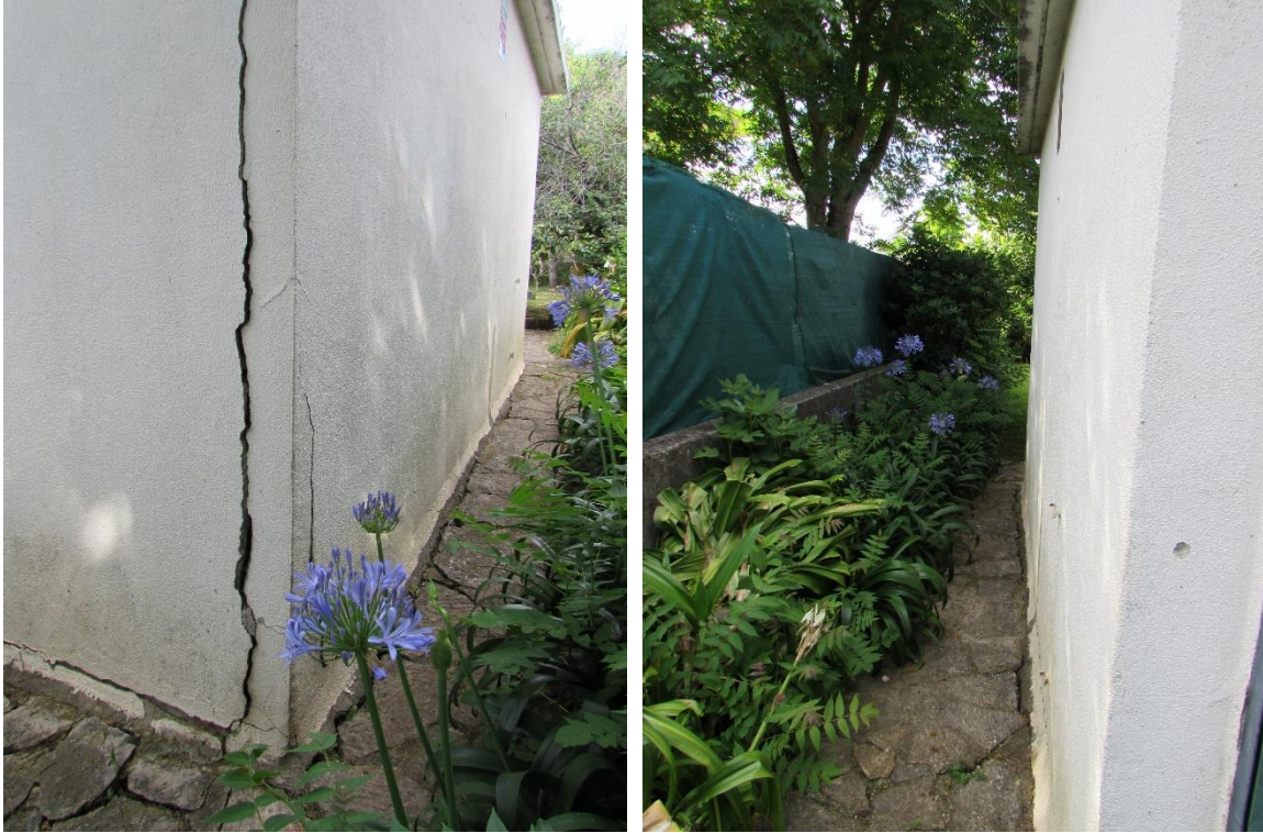
Fotografia 6 – Destacamento da parede de alvenaria sudeste da garagem relativamente à parede perpendicular e vista da extremidade oposta (sem sinais de danos)
