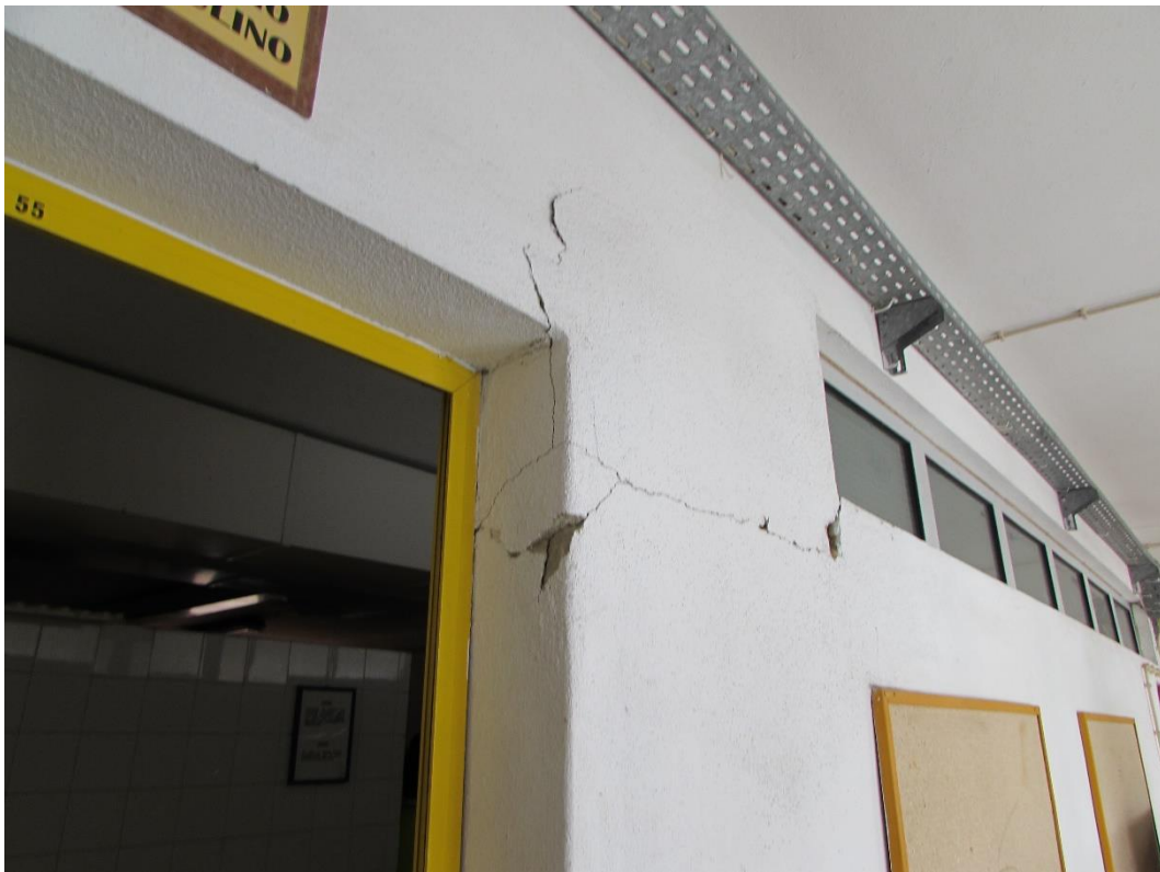
Fotografia 29 – Pavilhão desportivo: danos nas alvenarias em parede de balneário por assentamentos diferenciais
