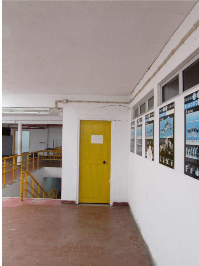
Fotografia 35 – Pavilhão desportivo: danos em alvenaria no hall do pavilhão
