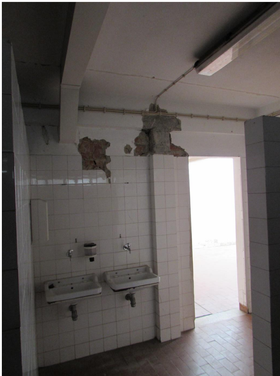
Fotografia 30 – Pavilhão desportivo: danos nas alvenarias em parede de balneário por assentamentos diferenciais
