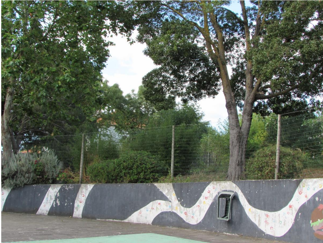
Fotografia 15 – EBI Dr. Joaquim de Barros: muro limítrofe oeste (sem sinais de deformação)
