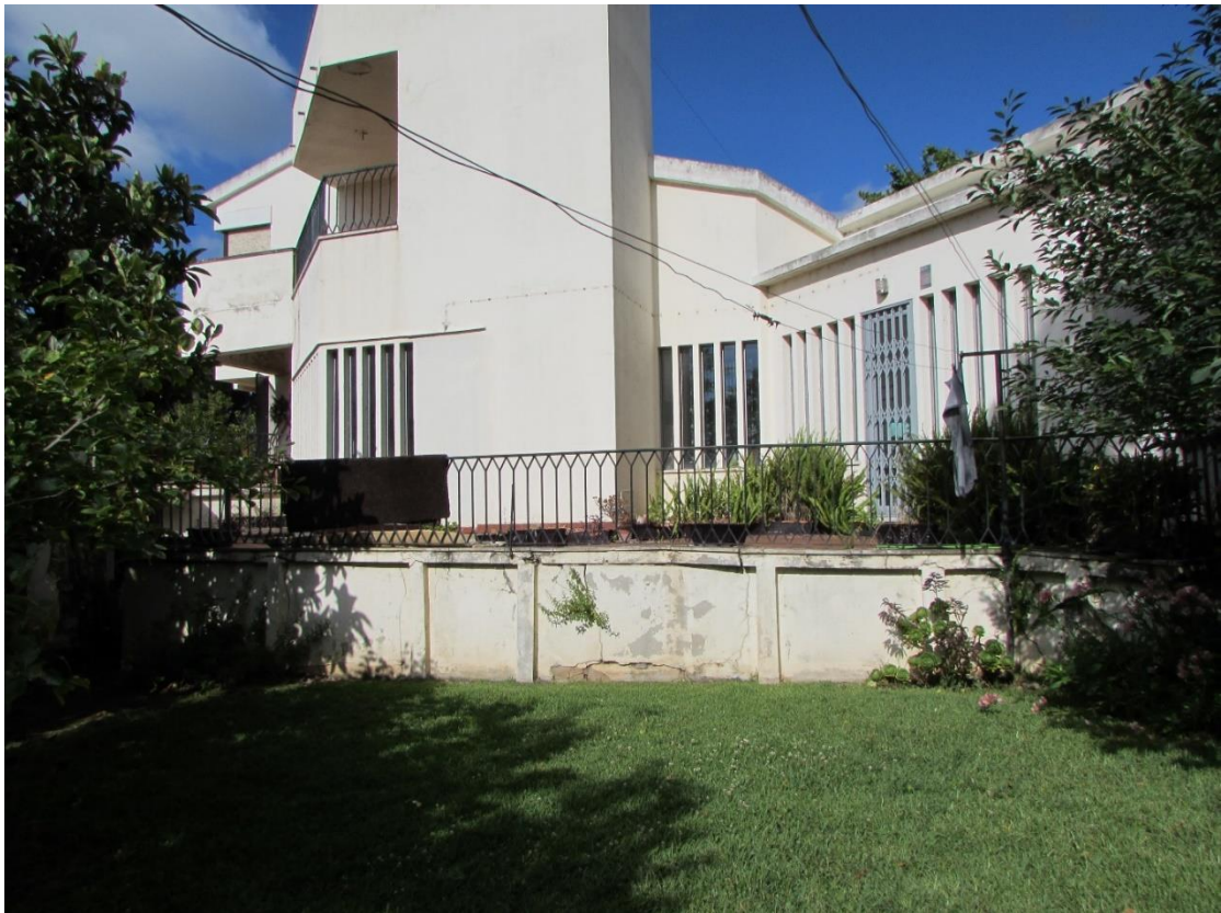
Fotografia 11 – Danificação da parede do terraço causada por assentamentos diferenciais
