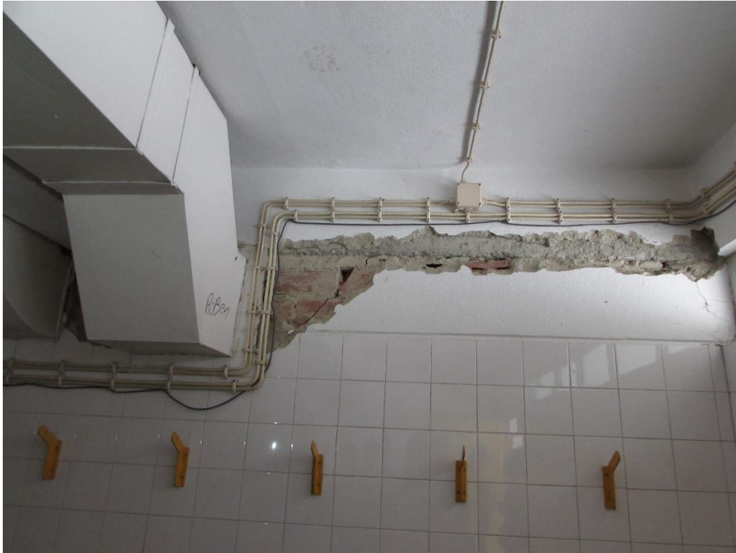
Fotografia 28 – Pavilhão desportivo: danos nas alvenarias em parede de balneário por assentamentos diferenciais
