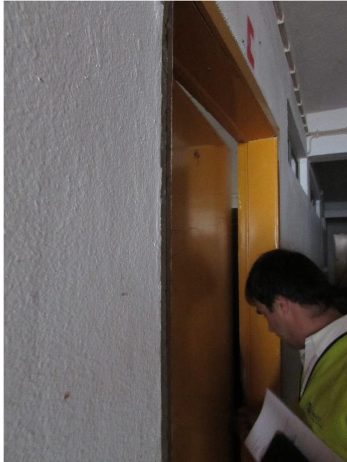
Fotografia 39 – Pavilhão desportivo: danos funcionais na zona de acesso ao campo
