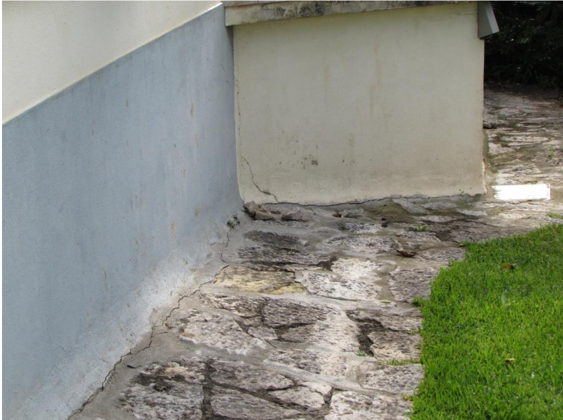
Fotografia 8 – Fissuração oblíqua na ligação da parede lateral de alvenaria do anexo em terraço à habitação (indício de assentamentos diferenciais)
