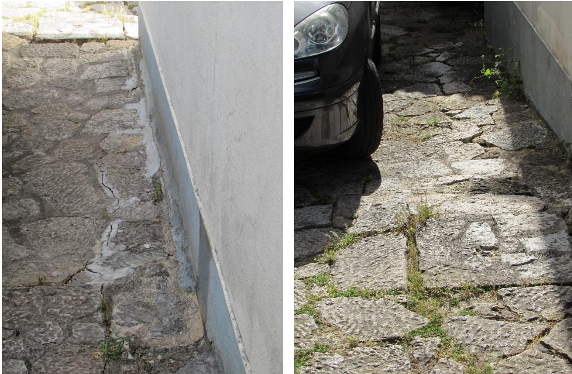
Fotografia 5 – Pavimento adjacente à parede noroeste da garagem
