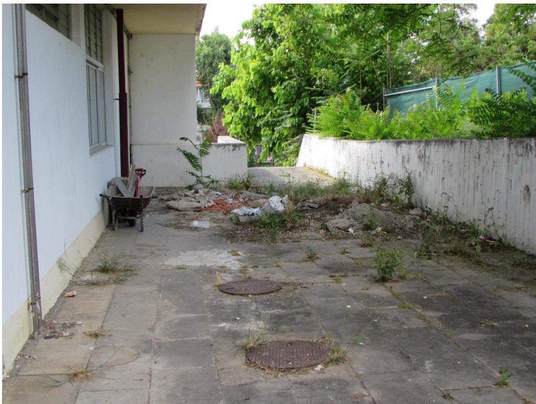
Fotografia 22 – EBI Dr. Joaquim de Barros: vereda confinante com o limite oeste do perímetro da escola; pormenor de abatimento junto a uma caixa de visita (2 de 2)
