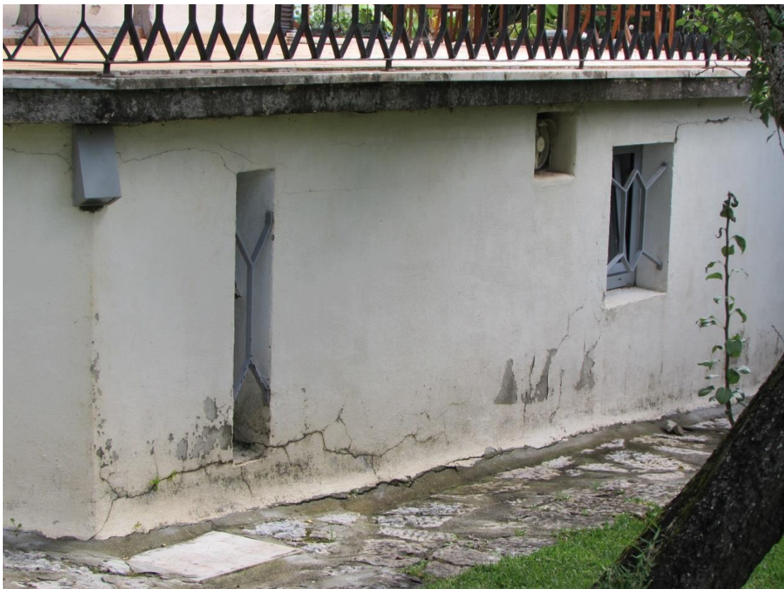
Fotografia 9 – Fissuração horizontal e sub-horizontal em torno de aberturas na parede do anexo em terraço (indício de assentamentos diferenciais)
