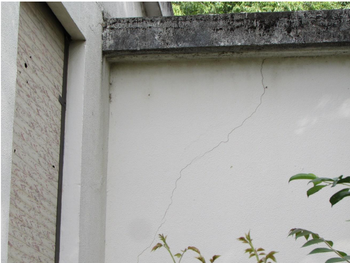
Fotografia 7 – Fendilhação oblíqua da parede sudoeste da garagem relativamente à habitação
