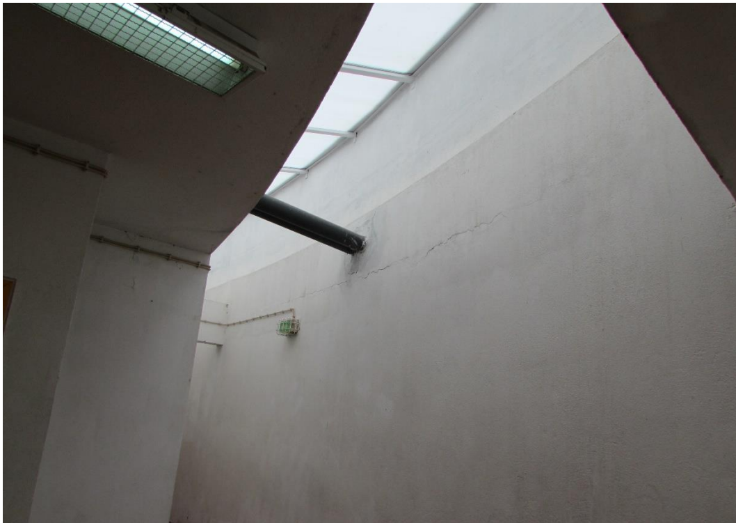
Fotografia 40 – Pavilhão desportivo: danos funcionais na zona de acesso ao campo
