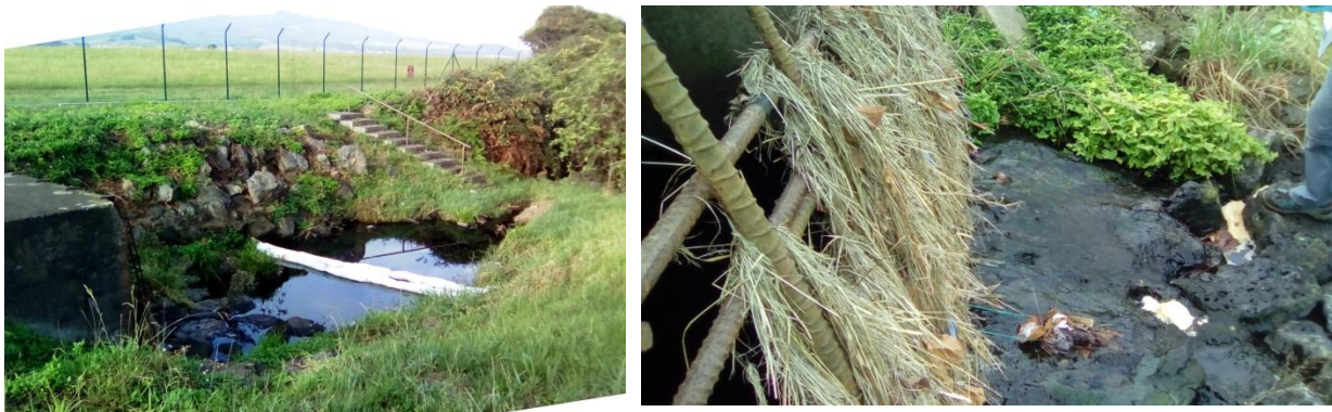
Figura 4.30 – Local de amostragem da água de escorrência da pista à saída do sistema de drenagem, Site 5003
