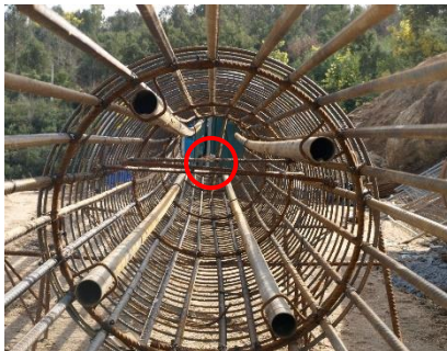
Figura 7. Extensómetro instalado na armadura de uma estaca.
