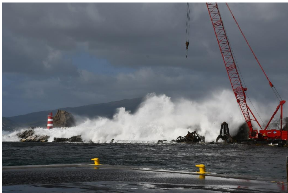
Figura 2.25 – Porto da Madalena do Pico. Foto dos estragos provocados pelo temporal de 6 de novembro de 2018
