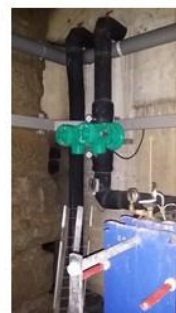
Equipamento existente no edifício
