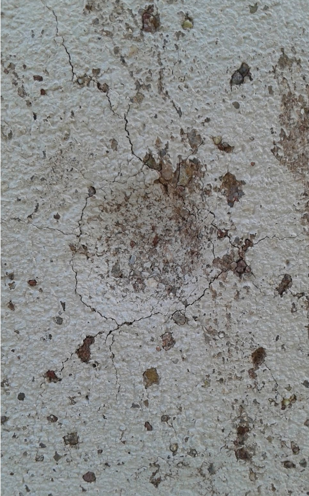
Figura 8. Aspeto da superfície do reboco E_WS+NHL no ensaio de Martinet-Baronnie, sendo visível a moessa acompanhada por fissuras.
