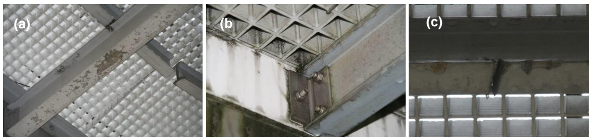
Figura 2: Anomalias: (a) marcas superficiais; (b) colonização biológica e corrosão de elementos metálicos nas ligações; (c) indentação num perfil transversal de travamento
