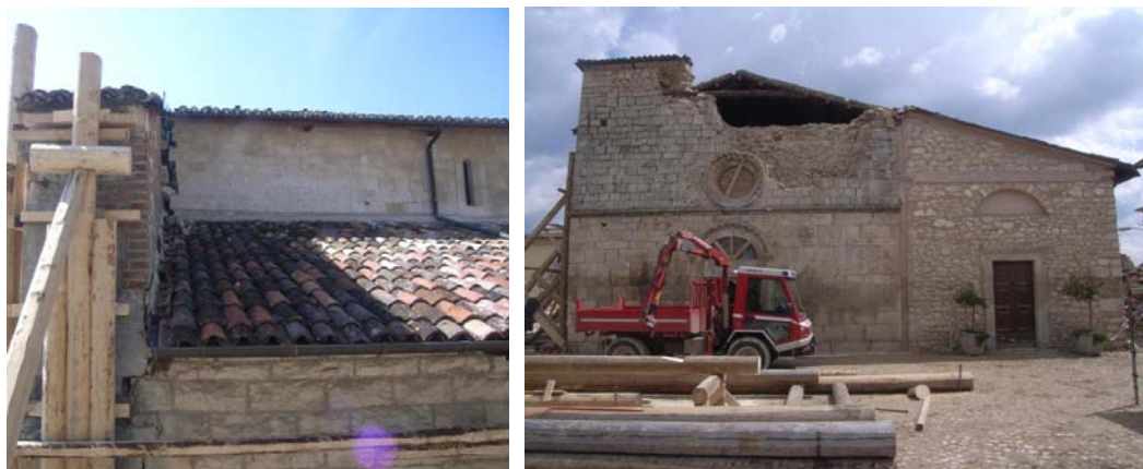
Figura 3. Activação do mecanismo de derrube global da fachada principal de uma igreja em L'Aquila (Mec.1, direita) e derrube do topo da fachada principal de uma igreja em Onna (Mec.2, esquerda).
