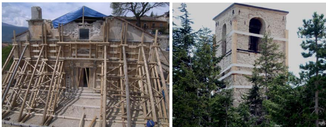
Figura 5. Escoramento de uma fachada principal da Catedral de Onna (esquerda) e de cintagem de uma torre sineira de uma igreja a 20km de L'Aquila (direita)
