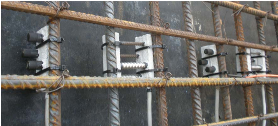
Figura 10. Sensores de R e I_{gal} instalados no betão de recobrimento na face de jusante da nervura (secção S2).
