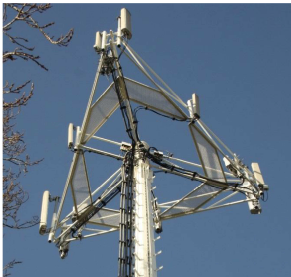
Figura 2. Interface de antenas no topo de um monopolo auto-suportado.
