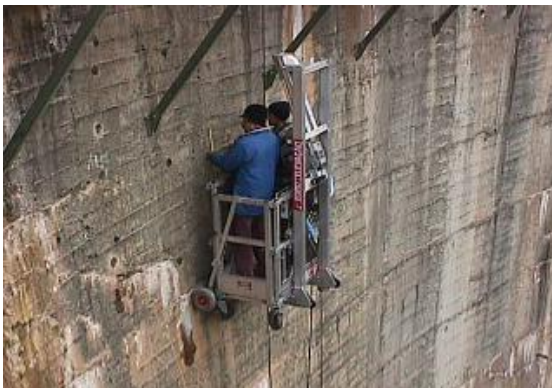
Figura 4.35 – Inspeção do paramento de jusante da barragem do Alto Ceira utilizando um bailéu.
