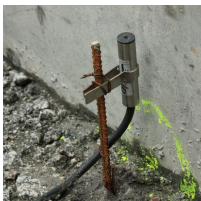
Figura 4.2 – Colocação de um termómetro junto ao paramento (em fundo a cofragem).
