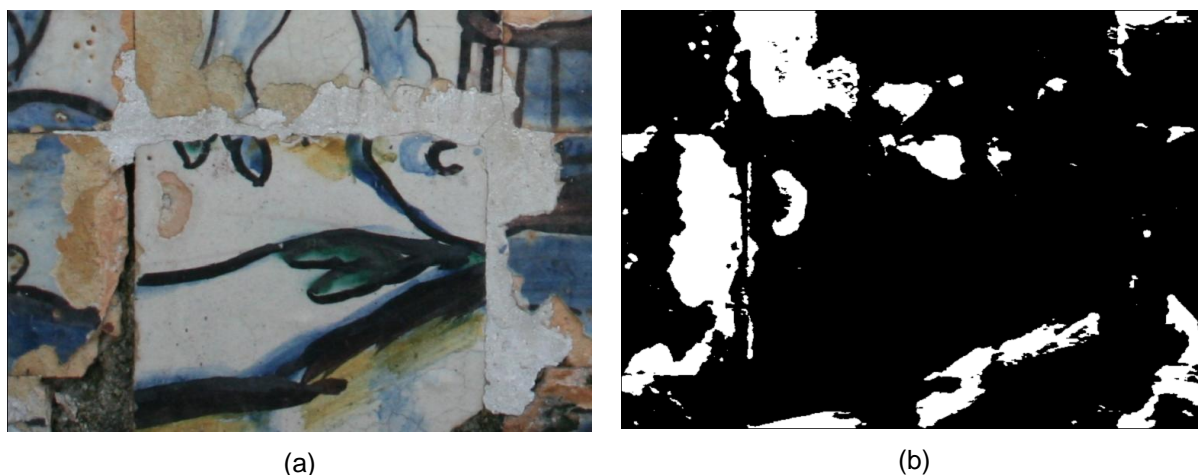
Figura 3.1 – Excerto de fotografia de um painel de azulejos (a) e imagem binária das zonas afetadas por falha de vidro construída com o GeMAPA (b).
