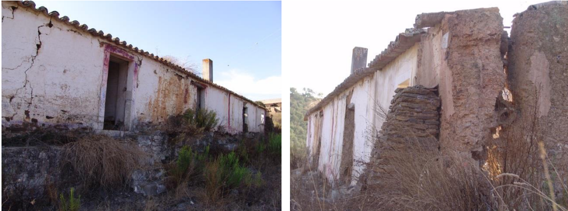
Figura 10.A. Alçado principal (sudeste) com o pormenor da zona de embasamento e do contraforte com pedra de xisto; visualização à direita do desligamento de duas paredes perpendiculares
