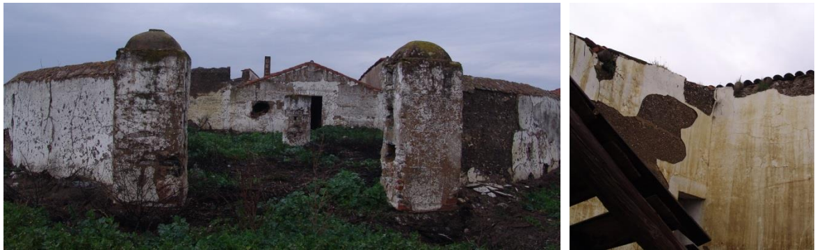
Figura 49.A. À esquerda, entrada para o edifício principal, visualizando o muro de taipa com o revestimento destacado, e à direita, interior do edifício visualizando-se também destacamento do revestimento
