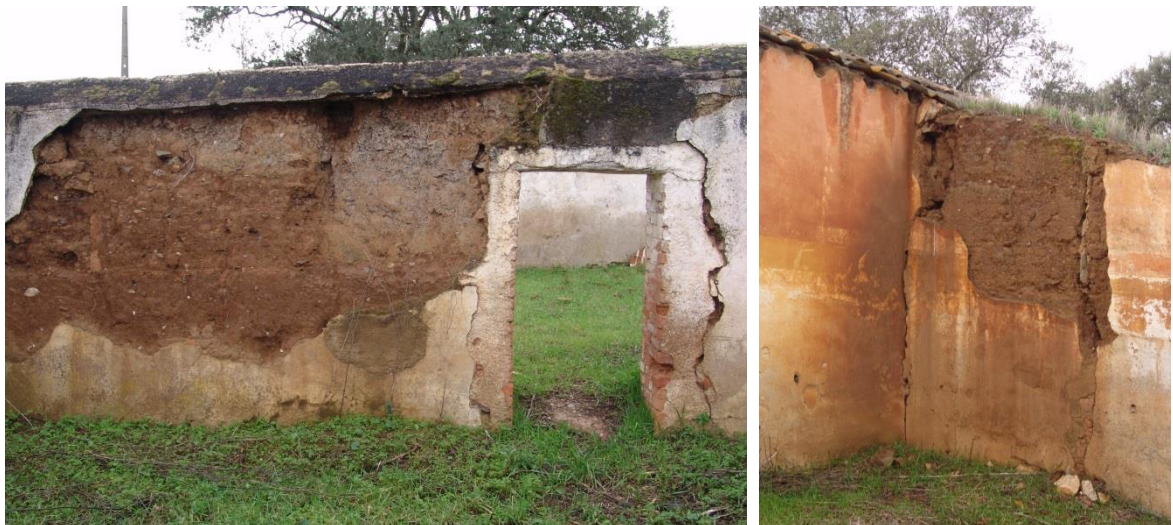
Figura 58.A. Destacamento do revestimento e consequente erosão da taipa
