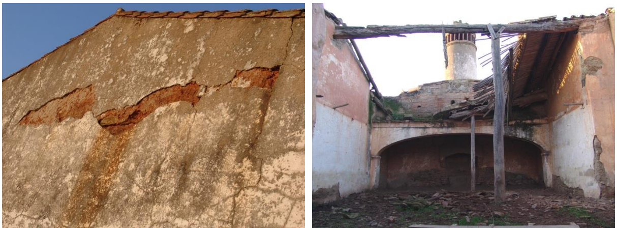
Figura 64.A. À esquerda, destacamento do revestimento, e à direita, interior do edifício (cozinha)
