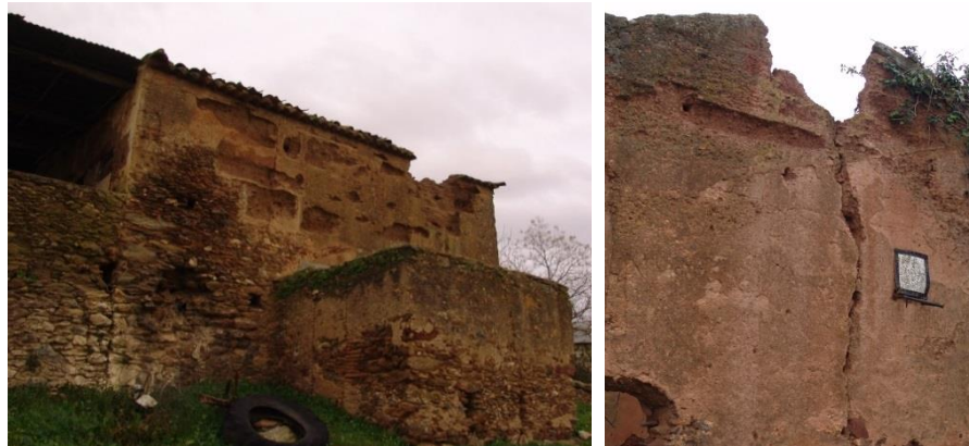
Figura 60.A. À esquerda, zona da taipa bastante degradada com perda de espessura na parede, e à direita, esmagamento no topo da parede e consequente fissuração devido ao peso da cobertura
