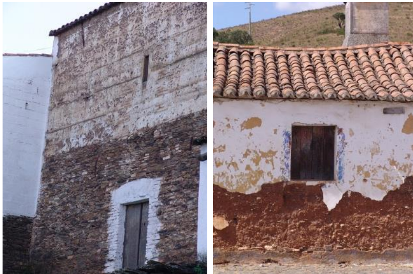
Figura 4.14. À esquerda, degradação superficial no revestimento de um paramento de taipa, na localidade de Barrancos; à direita, erosão da taipa associada à ascensão de água do terreno na localidade da Bemposta, Odemira
