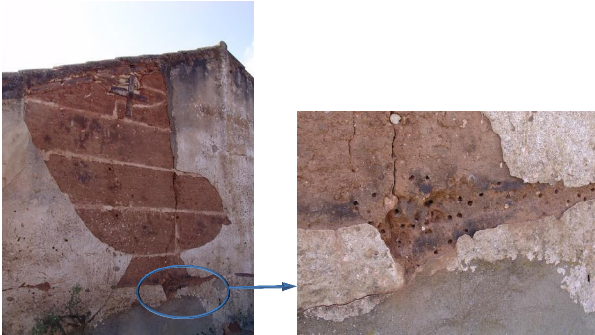
Figura 4.18. Nidificação de pequenos insetos nas paredes de taipa, na edificação localizada em Bicos, Cercal do Alentejo
