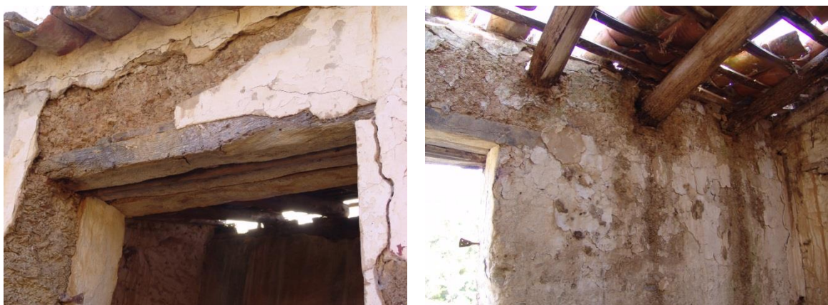
Figura 12.A. À esquerda, pormenor do lintel em madeira no vão de uma porta e destacamento da camada de reboco com perda de espessura da parede, e à direita, zona de entrega dos barrotes de madeira nas paredes de taipa
