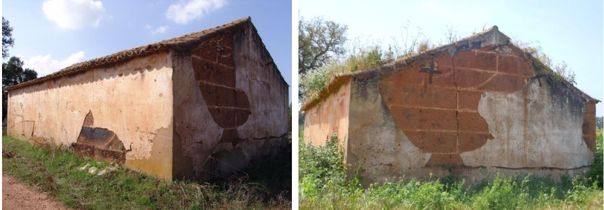
Figura 24.A. Alçado posterior (este) e alçado lateral esquerdo (norte), pode-se visualizar o destacamento da camada de revestimento e as ancoragens: à esquerda, em outubro de 2008; à direita, em abril de 2013 visualizando-se a contínua degradação na edificação
