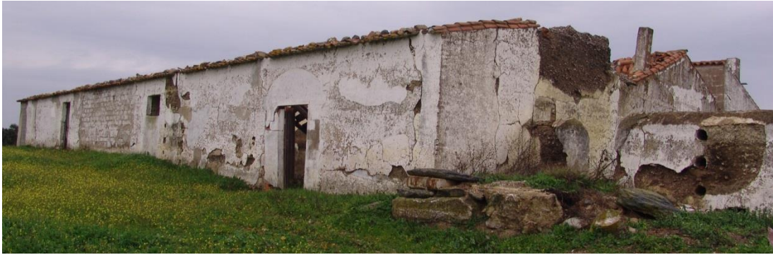
Figura 48.A. Alçado lateral esquerdo, visualizando-se uma degradação acentuada no revestimento e queda em algumas zonas
