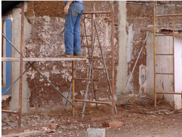
Figura 36.A. Criação de rugosidades na parede de taipa para receber uma argamassa cimentícia
