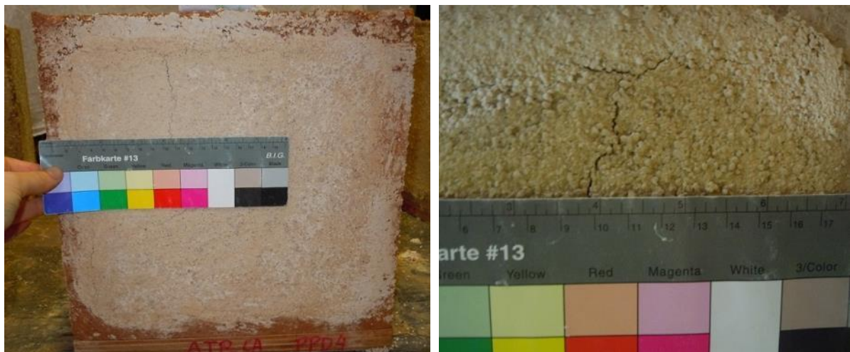
Figura 7.10. Fendas médias no defeito-padrão superficial: à esquerda, na argamassa ATP_CA15 aplicada no bloco BPD; à direita, na argamassa ATP_CH15 aplicada no bloco BVC
