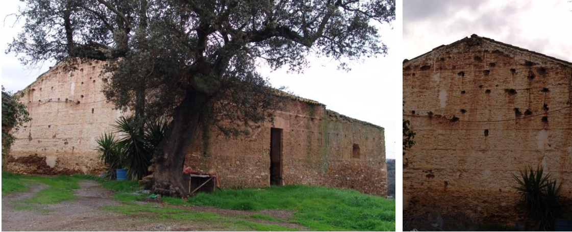
Figura 59.A. À esquerda, observam-se juntas em declive e o reforço com tijolo maciço nos vãos, e à direita, verifica-se a existência de cavidades profundas nas paredes de taipa
