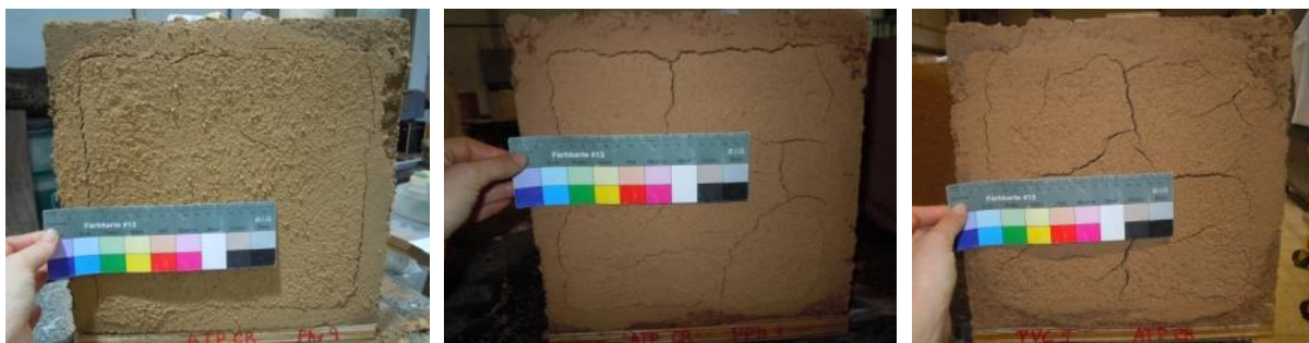
Figura 7.5. Fissuração e fendilhação verificada cerca de 3 horas após aplicação da argamassa ATP_CN15 no defeito-padrão superficial, nos blocos BAv, BPD e BVC, da esquerda para a direita
