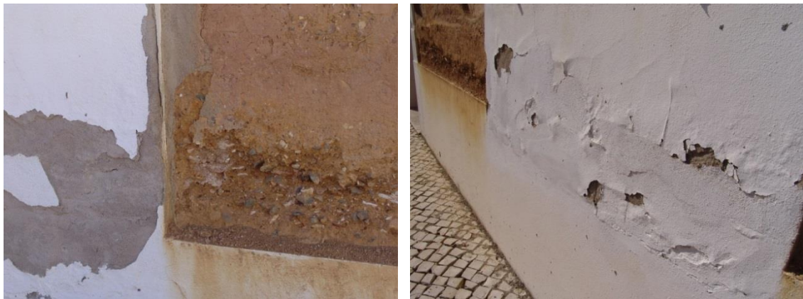
Figura 31.A. Perda de espessura na parede com perda de coesão da taipa e revestimento com baixa coesão, verificando o empolamento de tinta
