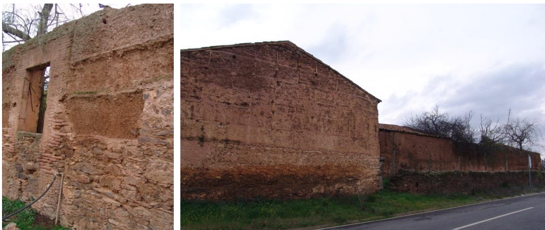
Figura 61.A. À esquerda, degradação na parede de taipa, e à direita, humidades ascensionais com crescimento de fungos/bolores
