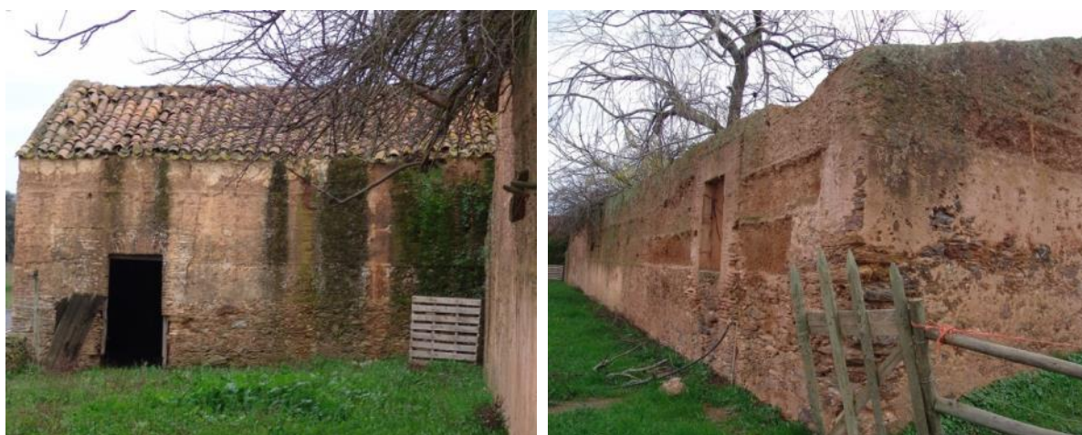
Figura 2.10. Herdade de Afonseanes no Sobral da Adiça, onde se pode visualizar o crescimento de fungos na superfície da parede de taipa
