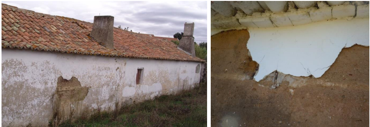
Figura 34.A. À esquerda, alçado posterior com destacamento de revestimento, e à direita, topo da parede de taipa, visualizando-se parte do tirante e o recurso a tijolo cozido para distribuição do peso de cobertura
