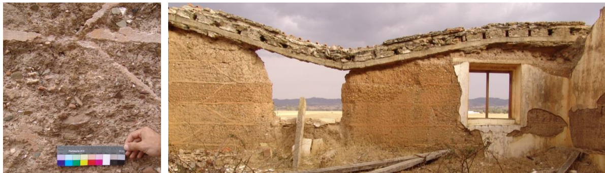
Figura 74.A. À esquerda, erosão da taipa, e à direita, juntas em declive, visualizando-se como a estrutura de cobertura apoiava nas paredes
