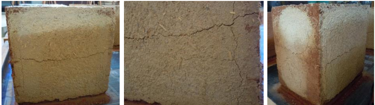
Figura 7.31. Bloco BPD ao fim de 120h em absorção capilar com a reparação da argamassa ATP_CA15_fib: à esquerda e ao centro, o pormenor de fissuras horizontais na zona da taipa e na zona da argamassa superficial e fissuras na delimitação entre a argamassa e o bloco; à direita, fissuras horizontais na taipa e na argamassa, com possível destacamento na zona inferior
