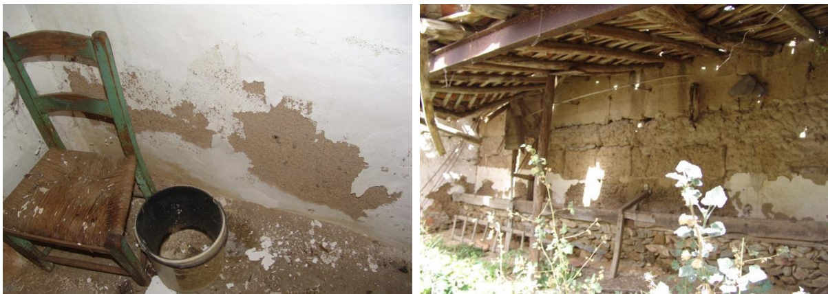
Figura 71.A. À esquerda, revestimento pulverulento e existência de sais devido ao acesso contínuo da água, e à direita, zona do alpendre
