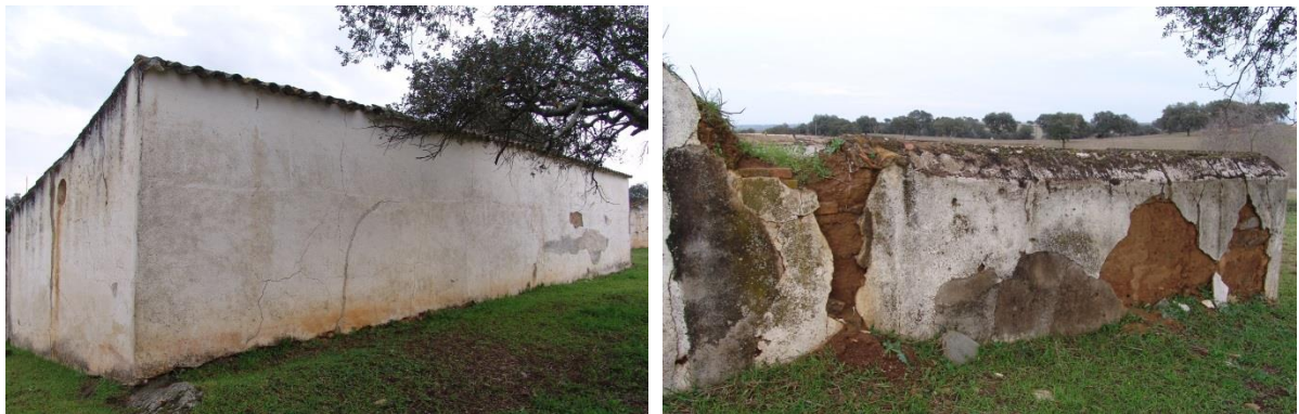
Figura 57.A. À esquerda, alçado posterior, e à direita, alçado lateral esquerdo visualizando algumas reparações efetuadas com argamassas cimentícias
