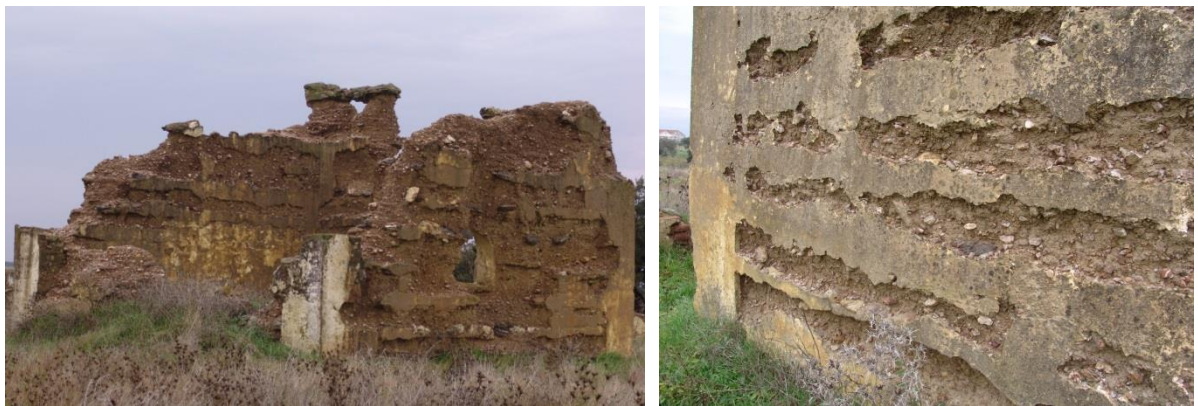
Figura 46.A. Parede de taipa bastante degradada e erodida
