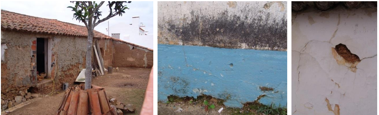
Figura 22.A. À esquerda, alçado posterior, ao centro, humidades ascensionais, e à direita, destacamento de reboco
