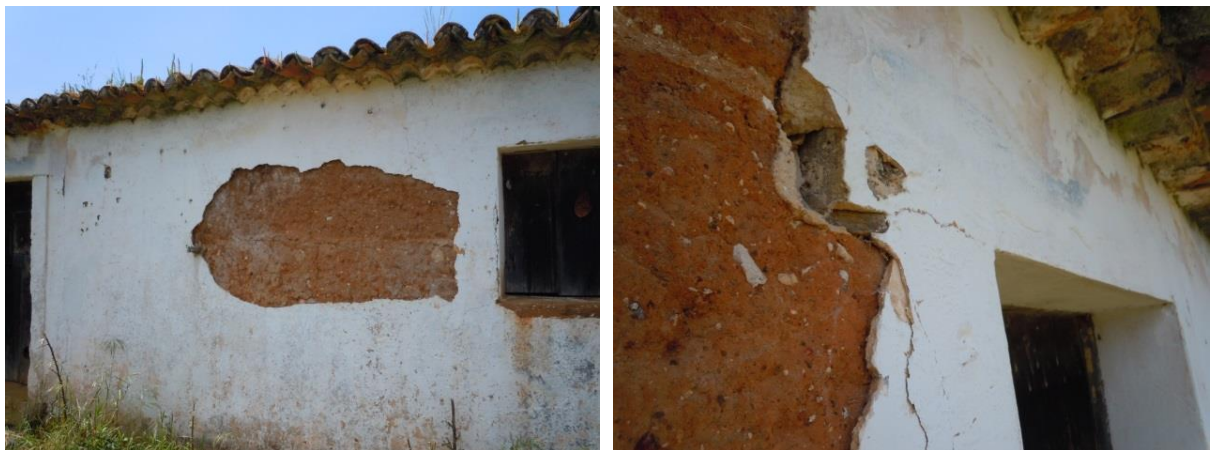
Figura 29.A. Em 2013: à esquerda, destacamento e queda da camada de reboco; à direita, lintel em betão no vão da porta
