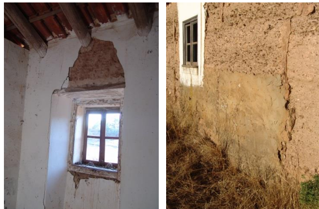
Figura 9.A. À esquerda, interior da edificação com queda de revestimento, e à direita, alçado posterior (oeste) visualizando a reparação da taipa com argamassas cimentícias
