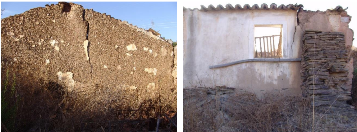
Figura 11.A. À esquerda, zona interior do alçado lateral direito (nordeste) visualizando uma fenda vertical, e à direita, pormenor do contraforte com fenda vertical na parede
