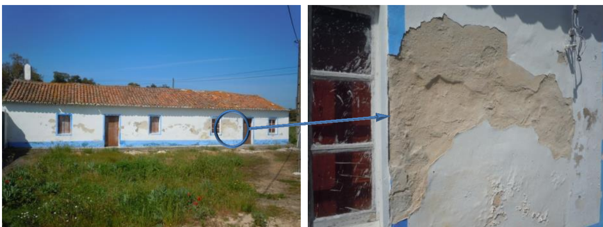
Figura 2.7. Edificação de taipa em S. Domingos, com um revestimento muito frágil, apresentando baixa coesão, e denotando elevada percentagem em areia e baixa percentagem em ligante
