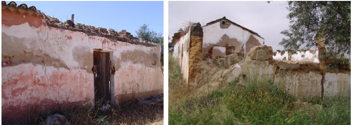
Figura 67.A. À esquerda, alçado principal (noroeste), e à direita, alçado lateral direito (sudeste)
