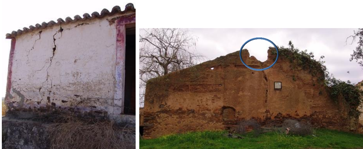
Figura 2.6. Esmagamento com fissuração vertical devido à estrutura da cobertura apoiar diretamente na parede de taipa: à esquerda, edificação nas Taliscas, Odemira; à direita, esmagamento com fissuração a partir da zona de apoio da cumeeira, na localidade de Sobral da Adiça
