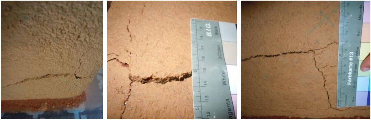
Figura 7.35. Bloco BPD com a aplicação da argamassa ATP_CN15 após terminada a fase de absorção de água por ascensão capilar, verificando-se fissuração acentuada e destacamento da argamassa
