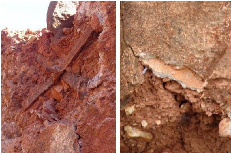
Figura 4.6. Edificação do Monte do Pá Danado, Odemira: à esquerda, utilização de tirantes em ferro forjado; à direita, duas camadas de reboco sobre a taipa
