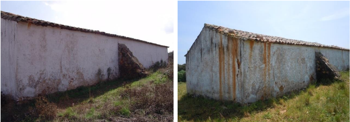
Figura 28.A. Alçado posterior com um contraforte: à esquerda, em outubro de 2008; à direita, em abril de 2013, visualizando-se uma degradação bastante mais acentuada
