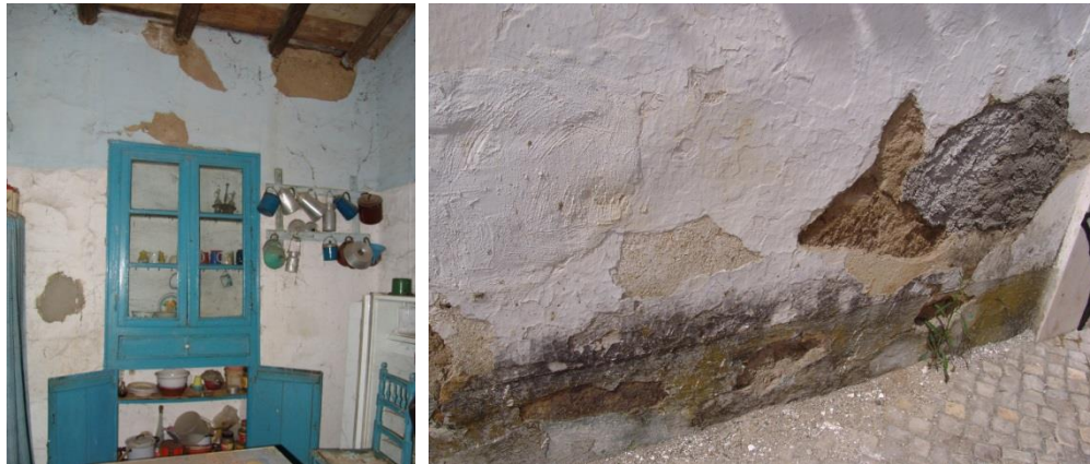
Figura 70.A. Degradação do revestimento: à esquerda, fissuração e destacamento; à direita, intervenção com argamassas cimentícias
