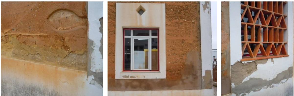
Figura 32.A. Em 2013: à esquerda, humidades ascensionais e perda de espessura da parede; ao centro, reparações efetuadas com uso de argamassas cimentícias; à direita degradação do revestimento com perda de coesão
