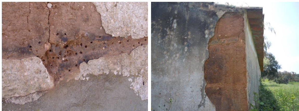
Figura 26.A. À esquerda, nidificação de insetos e zona de intervenção com argamassas de reparação cimentícias, e à direita, pormenor da inserção na parede de uma pedra de xisto na posição horizontal
