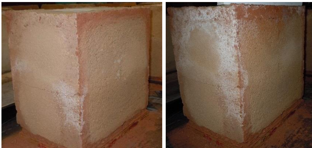
Figura 7.40. Bloco BPD com a aplicação da argamassa ATP, fase de absorção de água a partir do topo: à esquerda, antes de iniciar o 1º ciclo, já com algum aparecimento de eflorescências; à direita, 60 dias após ter terminada a fase, com maior incidência de eflorescências em especial na taipa
