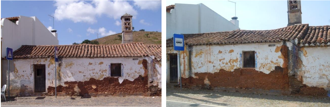
Figura 16.A. Alçado principal (sudeste): à esquerda, em agosto de 2008, visualizando-se na zona mais à esquerda a utilização de argamassas cimentícias; à direita, em agosto de 2013 visualizando-se a contínua degradação
