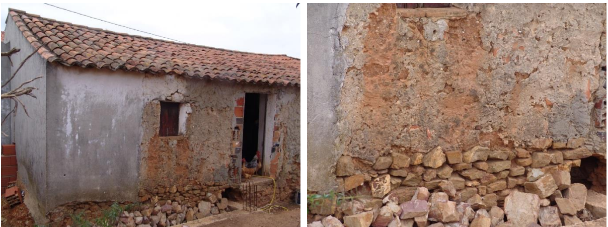
Figura 23.A. À esquerda, alçado posterior com a aplicação de um revestimento cimentício e utilização em algumas zonas argamassas de reparação também cimentícias, visualiza-se ainda uma viga de fundação que penetra para o interior da edificação onde se observam armaduras de espera, e à direita, pormenor da parede com argamassas cimentícias e da zona de embasamento
