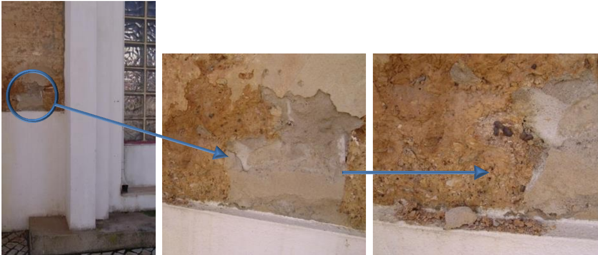
Figura 4.16. Utilização de argamassas de base cimentícia para colmatar a erosão no paramento de taipa, verificando o destacamento das mesmas e a nidificação de pequenos insetos no seu interior, Mercado de São Luís, Odemira
