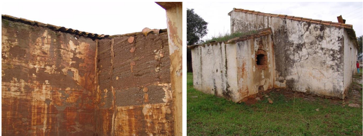
Figura 54.A. À esquerda, interior da edificação com o destacamento do revestimento, e à direita, alçado lateral esquerdo visualizando-se o forno e fissuração excessiva do revestimento, existência de fungos/bolores
