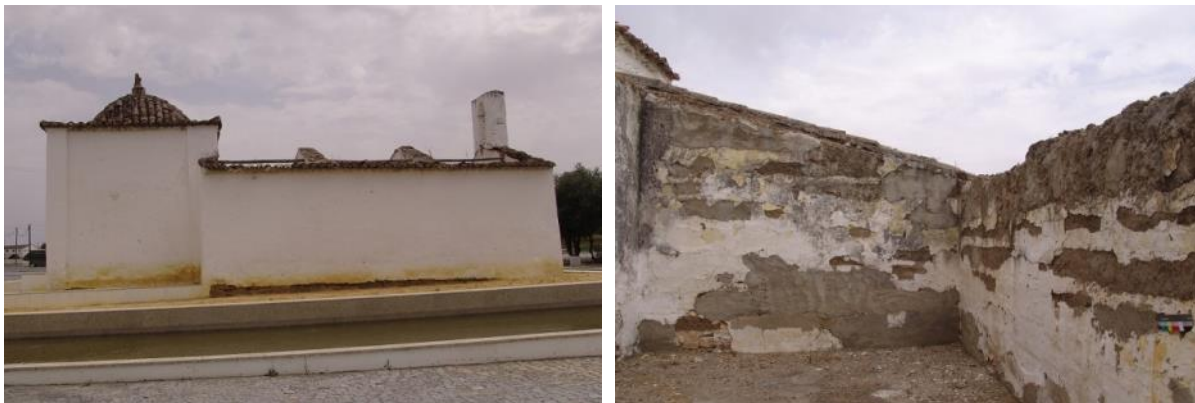
Figura 2.9. Ermida de S. Sebastião em Ferreira do Alentejo: à esquerda, fenómenos visíveis de ascensão de água por capilaridade; à direita, utilização de argamassas cimentícias para reparação do paramento de taipa
