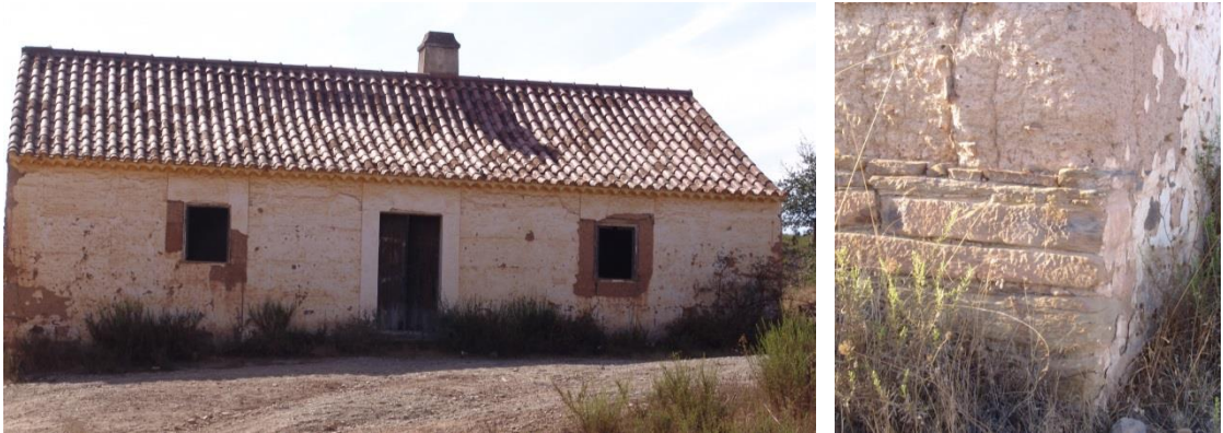
Figura 7.A. À esquerda, alçado principal (este), e à direita, pormenor da zona de embasamento com pedra de xisto
