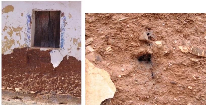
Figura 17.A. Taipa bastante erodida e degradada, visualizando-se a nidificação de insetos
