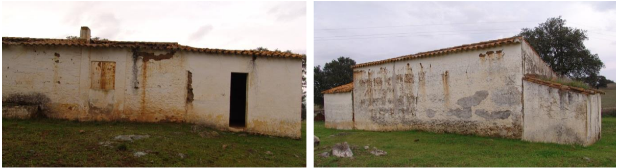
Figura 53.A. À esquerda, alçado principal, e à direita, alçado posterior com a utilização de argamassas cimentícias para tapar alguma degradação na taipa
