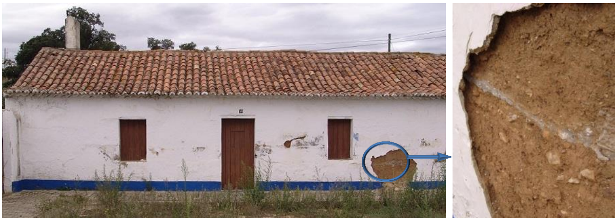
Figura 4.17. Utilização de argamassas de revestimento de base cimentícia, verificando-se o destacamento, no estudo de caso localizado em S. Domingos, Santiago do Cacém
