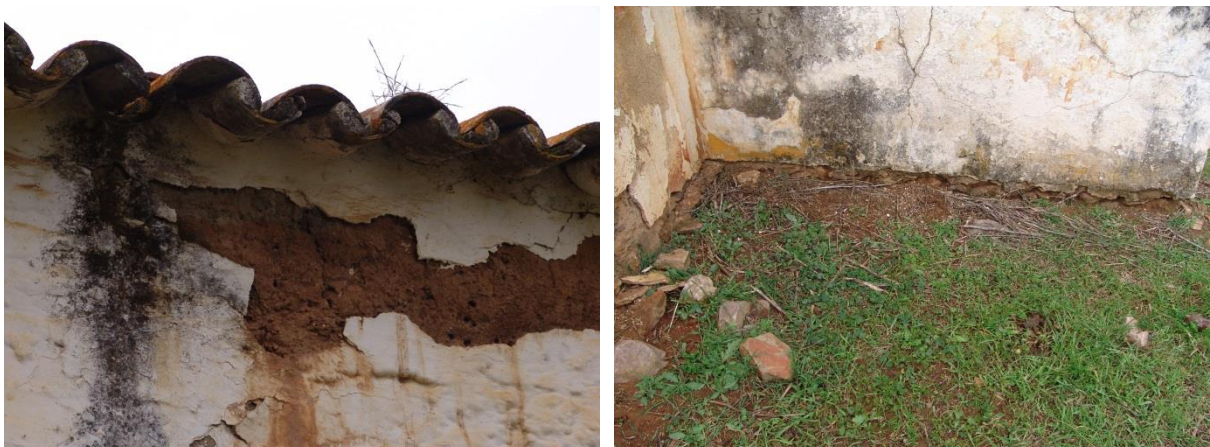
Figura 55.A. À esquerda, pequenos orifícios na taipa devido à nidificação de insetos, e à direita, pormenor da zona do embasamento com a utilização de alvenaria de pedra
