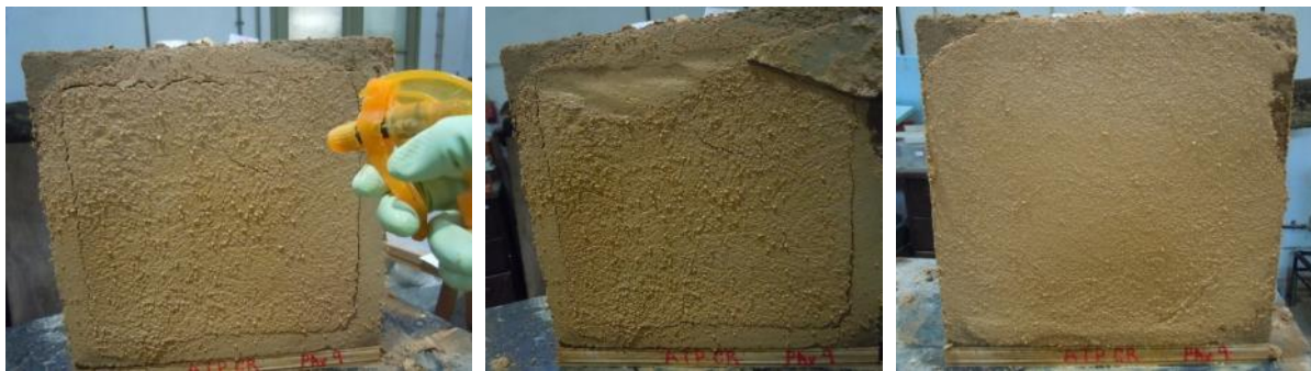
Figura 7.7. Refechamento de fendas no bloco BAv com a aplicação da argamassa ATP_CN15: à esquerda, aspersão com água; ao centro, aperto da argamassa na zona a intervir; à direita, argamassa após intervenção
