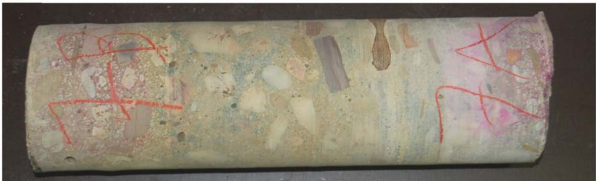
Carote 7: Viaduto 2; Pilar Parede N°7; ( \varnothing = 92 mm; comp. máx= 321 mm); Dimensão do agregado > 1/3 \varnothing
