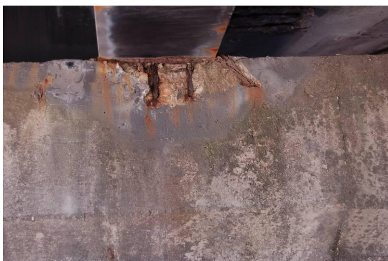
Figura 16: Intervenção existente, degradada, na zona de ligação dos pilares com o tabuleiro
