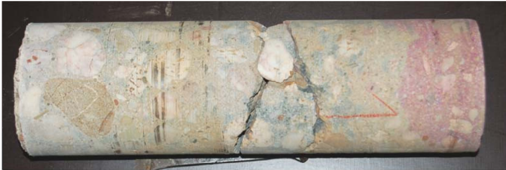
Carote 1: Viaduto 1; Pilar Parede Nº3; ( \text{Ø} = 101 \text{ mm} ; comp. máx= 330 mm); Dimensão do agregado > 1/3 \text{ Ø}
