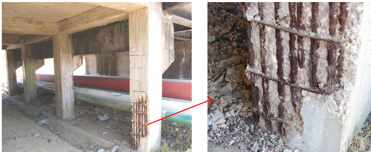
Figura 10: Face oeste do pilar sul, encontro oeste do viaduto 9/10 (mais a sul). Armaduras corroídas
