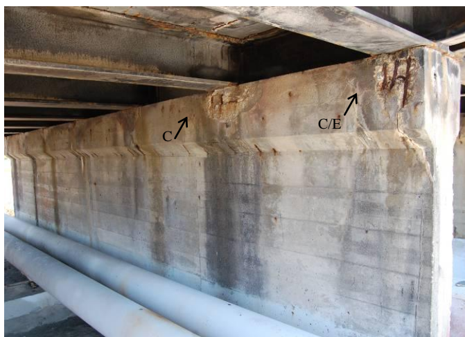
a) Rotura por corte e esmagamento
