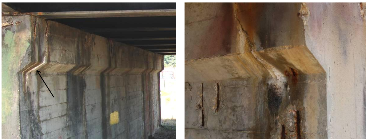
Figura 14: Desenvolvimento de incrustações em fissuras nos pilares parede
