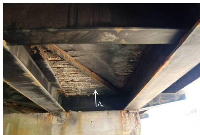
Figura 48: Degradação do betão armado em mais de metade da área exposta da laje pré-fabricada do tabuleiro do viaduto 9/10 (face inferior)
