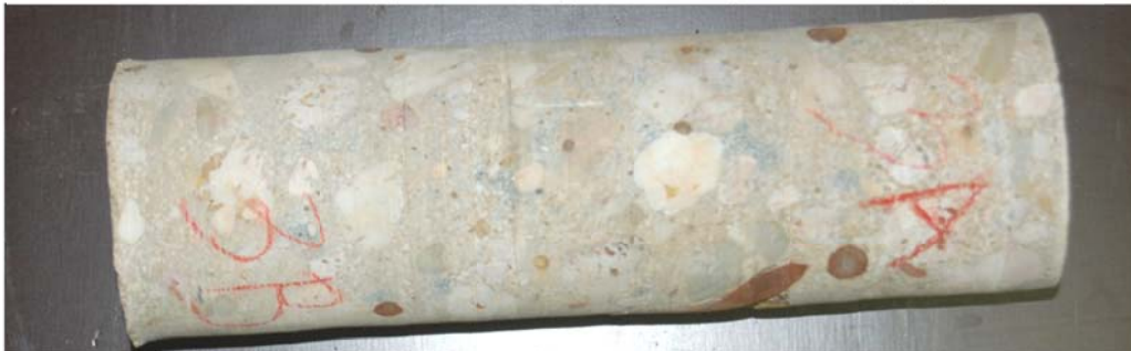
Carote 3: Viaduto 1; Pilar Parede Nº3; ( \text{Ø} = 92 \text{ mm} ; comp. máx= 305 mm); Dimensão do agregado > 1/3 \text{ Ø}
