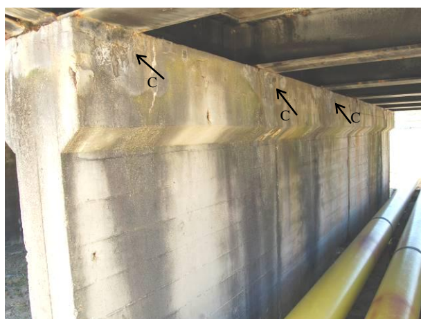
Figura 49: Degradação do betão armado em menos de metade da área exposta e concentrada na zona de espessamento do pilar parede 1 (PP1) do viaduto 9/10
