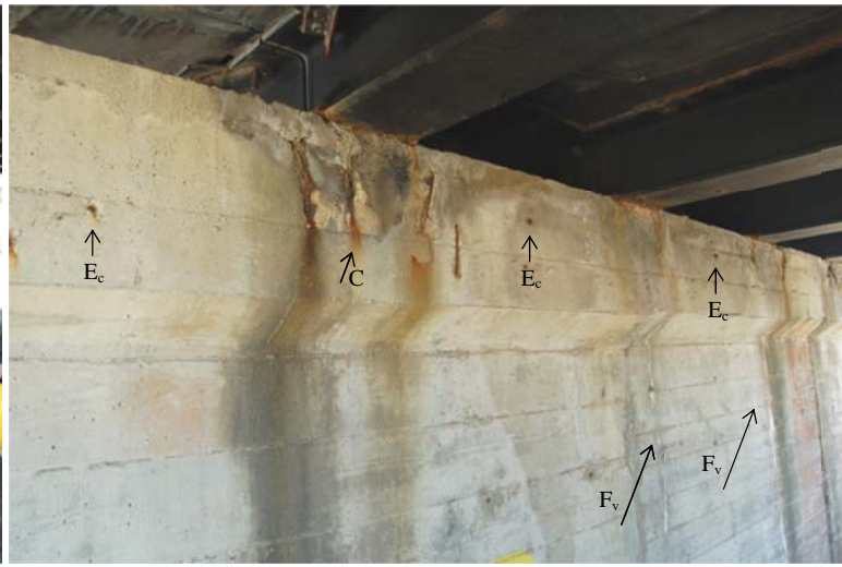
Fig. A.20: Face este: existência de reparação prévia degradada
