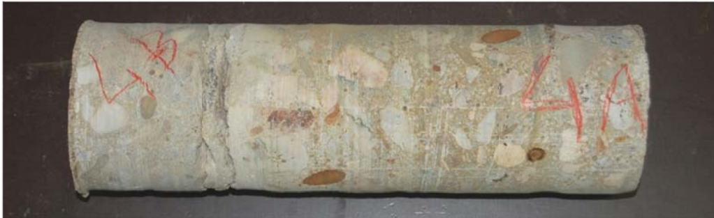
Carote 4: Viaduto 1; Pilar Parede Nº3; ( \text{Ø} = 92 \text{ mm} ; comp. máx= 305 mm); Dimensão do agregado > 1/3 \text{ Ø}
