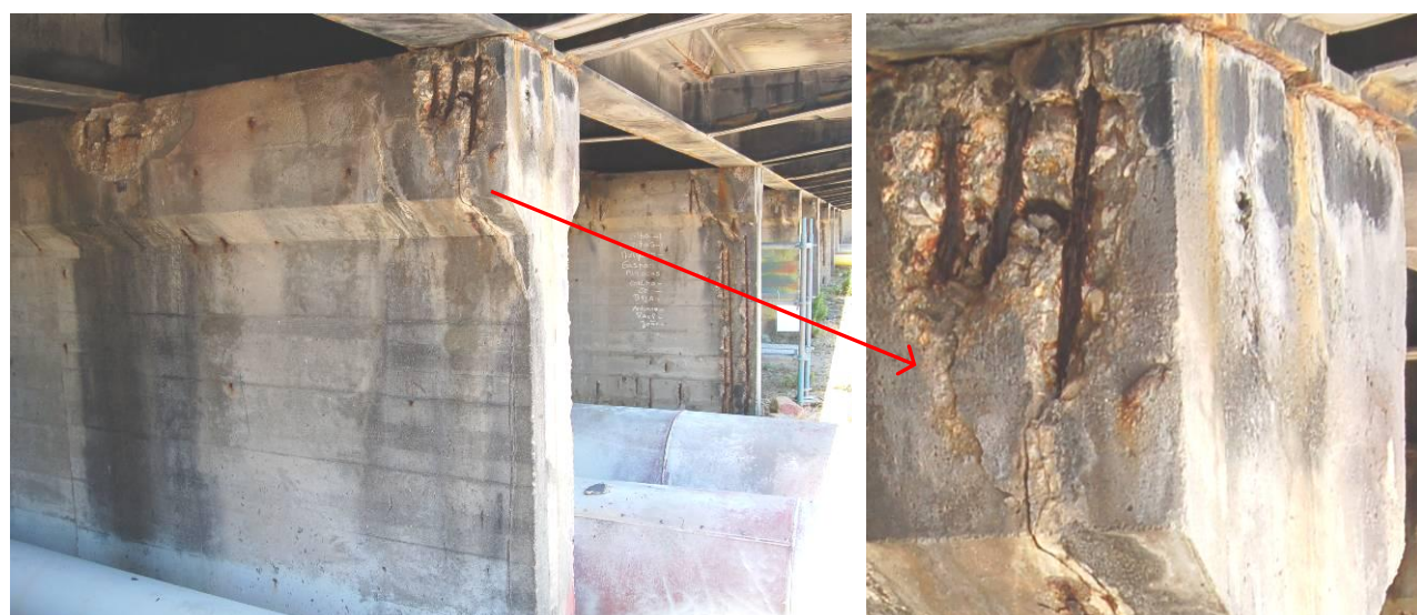
Figura 12: Faces sul e oeste do pilar parede N1, viaduto 4/5 (mais a norte). Armaduras corroídas
