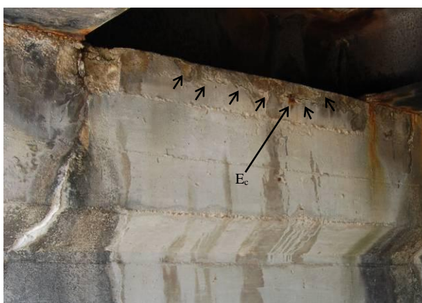
Figura 13: Delaminação mais alargada do betão de recobrimento na aresta devido à corrosão do espaçador ( E_c )
