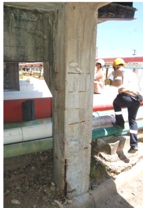
Fig. A.5: Pilar sul, faces oeste e norte: armadura corroída exposta
