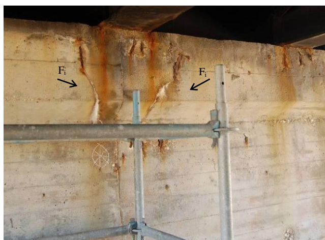
Figura 7: Fissura inclinada na zona de espessamento dos pilares parede, zona interior ( F_i )
