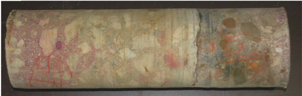
Carote 6: Viaduto 2; Pilar Parede N°7; ( \varnothing = 92 mm; comp. máx= 321 mm); Dimensão do agregado > 1/3 \varnothing
