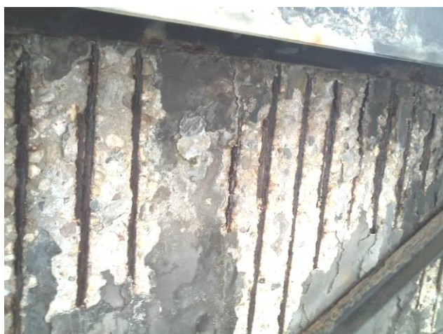
Figura 3: Armadura corroída exposta nas lajes pré-fabricadas do tabuleiro (A c )
