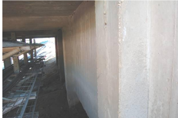
Figura 23: Medição da espessura do recobrimento no pilar parede junto do terreno do encontro oeste do viaduto entre os postos de acostagem 4/5 (norte)
