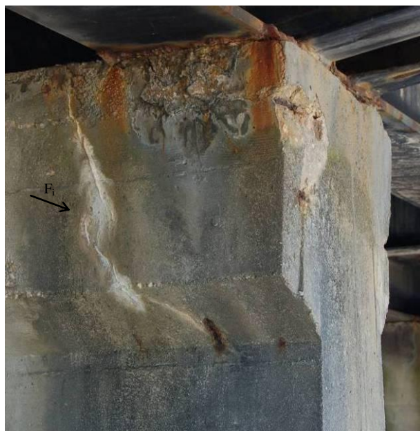
a) Fissura inclinada
