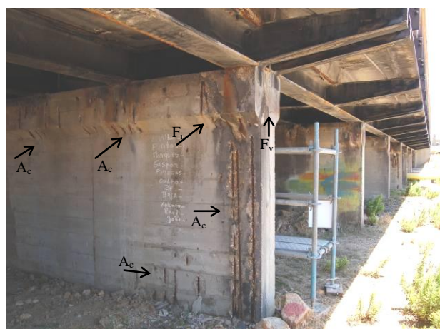
Figura 50: Degradação do betão armado em menos de metade da área exposta e abrangendo a totalidade do pilar parede 2 (PP2) (zona de espessamento e restante comprimento visível). Viaduto 4/5
