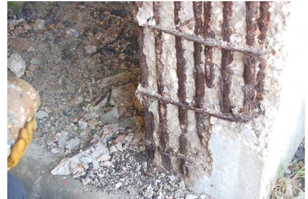
Fig. A.7: Pormenor da redução de secção das armaduras
