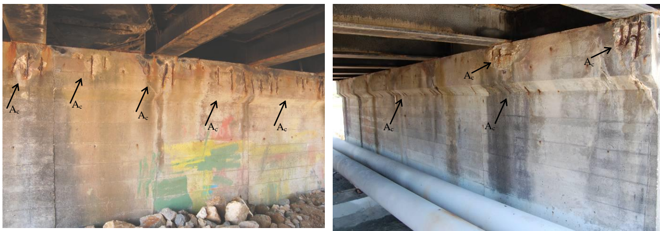
Armadura corroída na zona de espessamento do pilar parede e na zona de contacto com a estrutura metálica Figura 2: Armadura corroída exposta nos pilares parede (A c )
