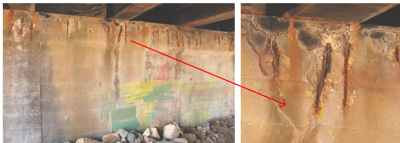
Figura 11: Face oeste do pilar parede N3, viaduto 4/5 (mais a norte). Armaduras corroídas
