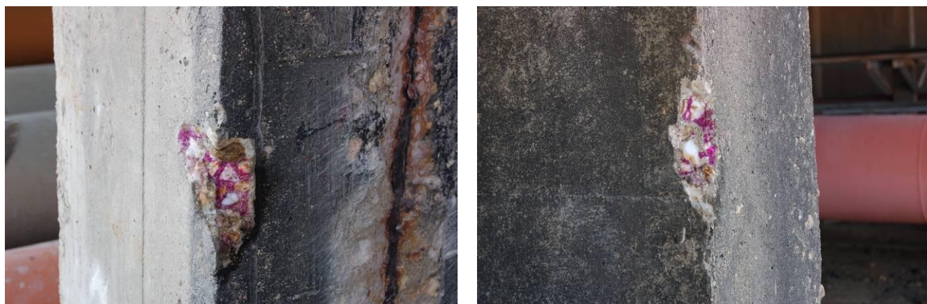
Figura 29: Profundidade de carbonatação do betão nos pilares parede do viaduto entre os postos de acostagem 4/5
