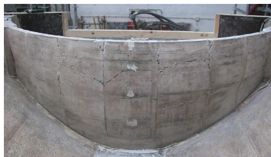
Fig. 6 – Vista de montante do modelo após a rotura.
