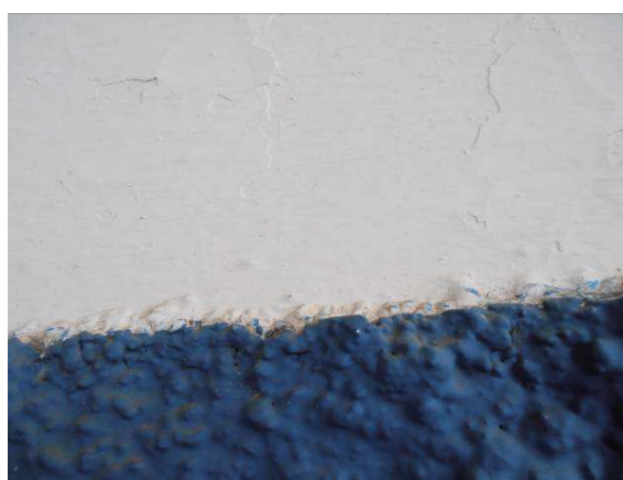
Fig. 12 – Pormenor (do mercado da freguesia de Salvada) onde é visível a diferença de texturas e brilho da tinta sintética (azul) para a cal (branca)
