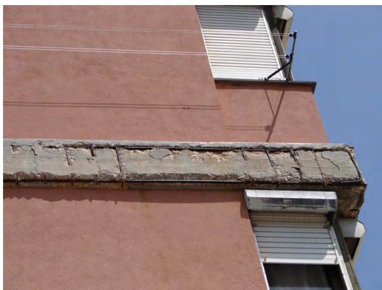
Figura 1.2 – Destacamento do betão de recobrimento e corrosão de armadura em viga
