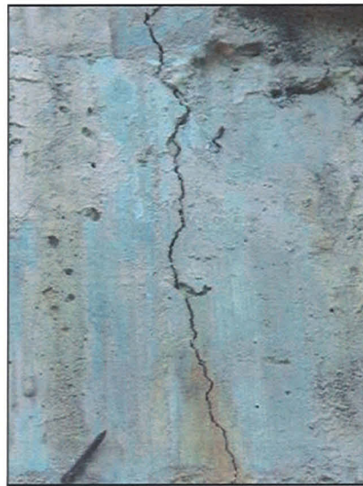
Figura 1 – Fenda em paramento de barragem.
