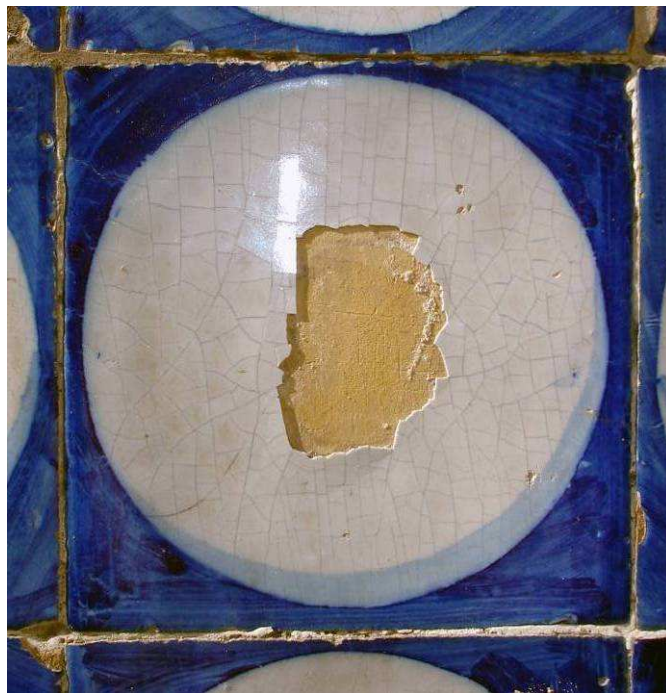
Figura 22- Queda em mosaico em que o vidrado está completamente separado da chacota, como a sombra resultante da iluminação vinda da esquerda evidencia – Beco do Belo (azulejo da Fábrica Roseira)
