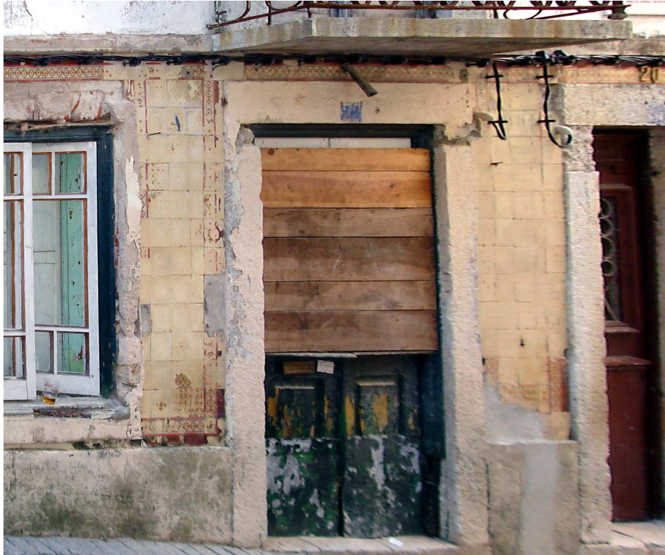
Figura 40- Em alguns casos esta é inexoravelmente a situação expectável se não forem atempadamente tomadas medidas de conservação (edifício no Ribatejo)
