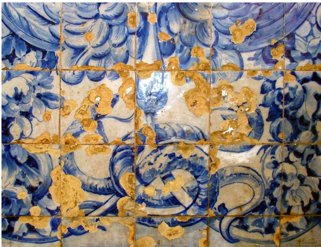
Figura 29- Queda presumivelmente por descasque na parte inferior da decoração da antiga fábrica de balanças às Cruzes da Sé (azulejos marcados “Fáb. Roseira, 1918”)
