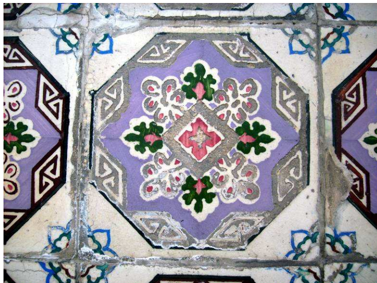
Figura 34- Queda do vidro afectando as áreas de cor castanha que aqui se apresentam cinzentas
