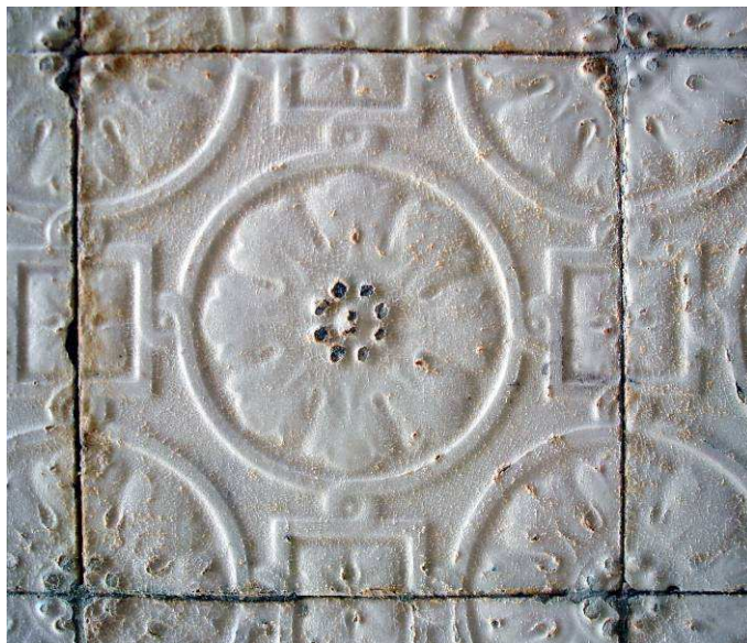
Figura 31- Queda do vidro nas partes mais salientes de azulejos de pó de pedra (Rua do Poço da Cidade)
