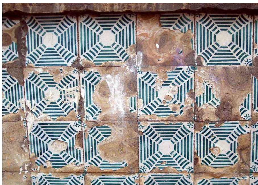
Figura 26- Estádio terminal da degradação com sinais de cristalizações salinas
