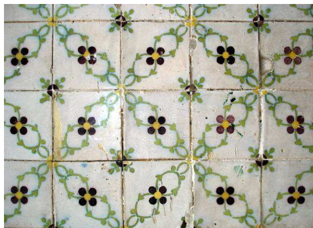
Figura 2b- Padrão de azulejo D. Maria na fachada da Rua do Diário de Notícias
