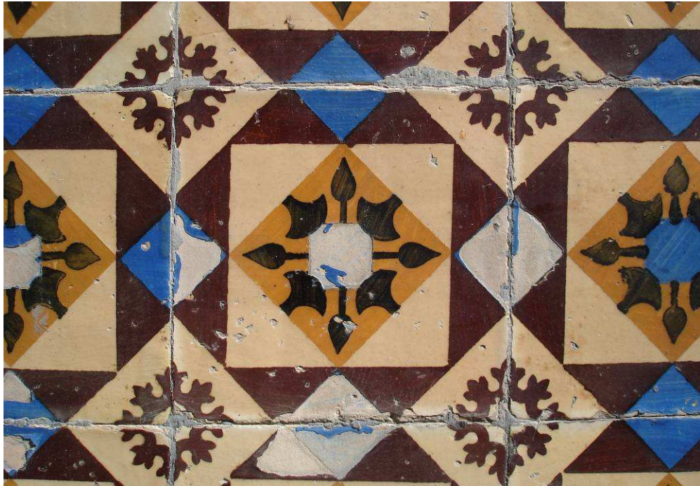
Figura 33- Queda do vidro afectando principalmente as áreas azuis
