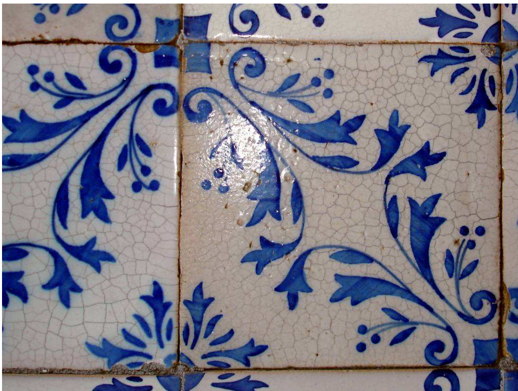
Figura 15- Padrão de craquelé em azulejos de fachada
