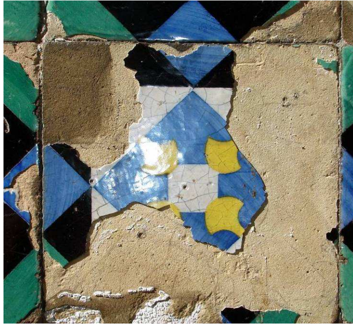
Figura 21- Perda quase total do vidrado num azulejo com craquelé de tipo II – edifício da Figura 16 na Rua do Teixeira
