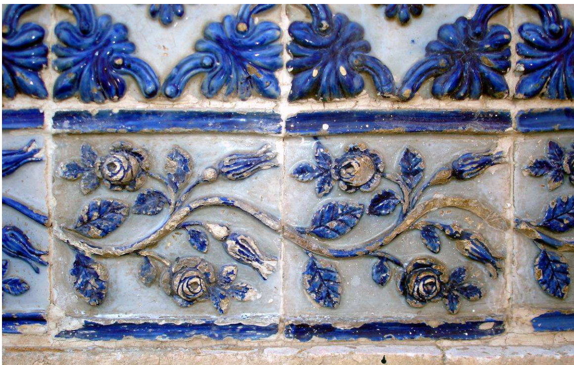
Figura 32- Típica queda do vidrado nas partes convexas de azulejos de fabricação provavelmente nortenha aplicados em Lisboa (Rua de São João da Mata à Lapa)
