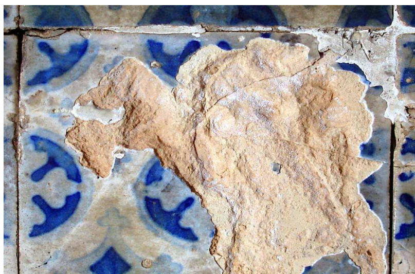
Figura 38- Desagregação da chacota, possivelmente provocada por cristalização de sais solúveis em zona ribeirinha (L. do Corpo Santo)
