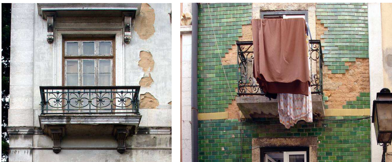
Figura 11a- Num prédio mal mantido as infiltrações pelos enquadramentos dos vãos, roturas de canalizações (incluindo tubos de queda oclusos na fachada ou sobrepostos), etc, evidenciam-se por manchas e perdas de reboco. Da mesma maneira, nas fachadas azulejadas as mesmas infiltrações evidenciam-se frequentemente através do destacamento dos azulejos (Figura 11b) – ambas as imagens foram tomadas no Bairro Alto
