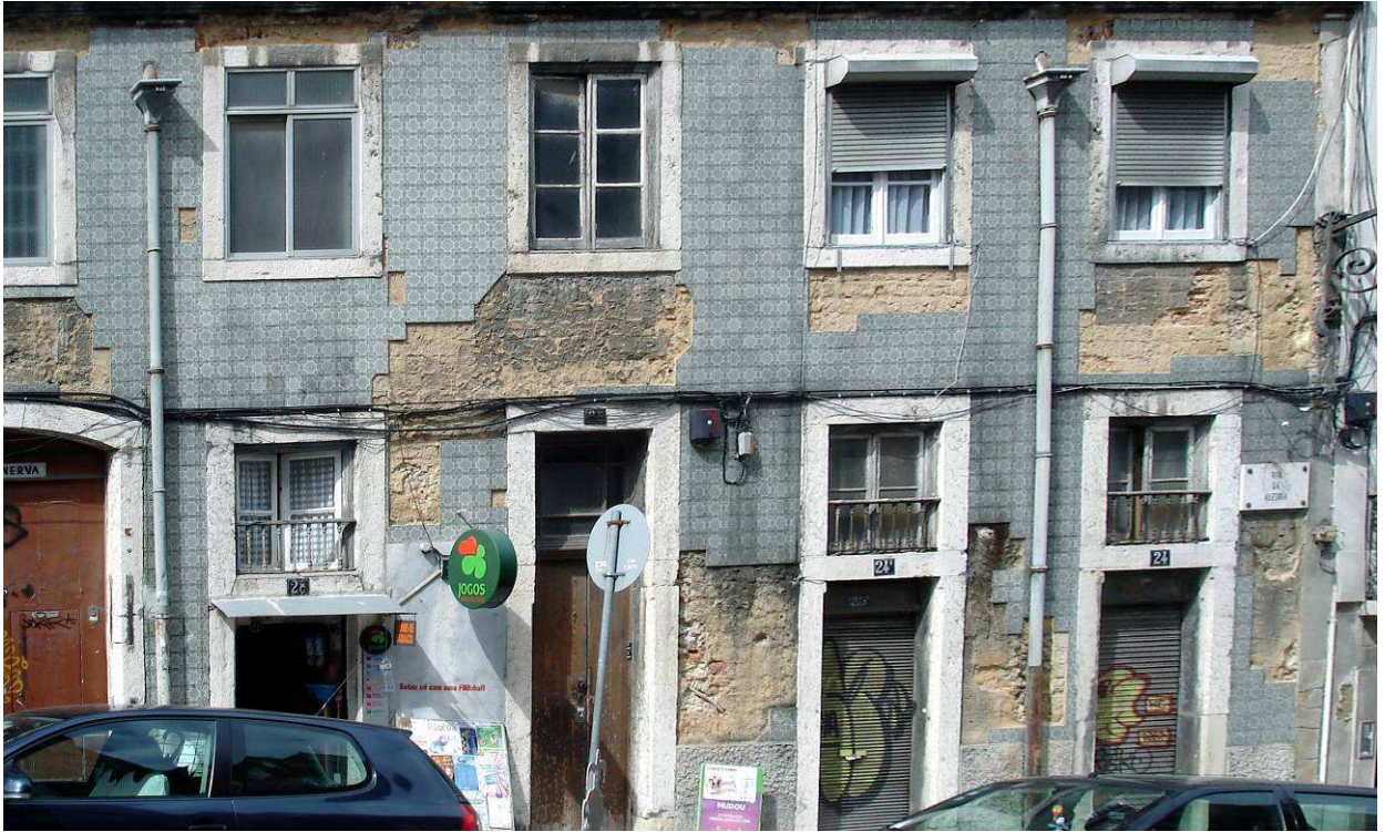
Figura 12- Fachada na Rua da Alegria com muitas áreas em perda - através das lacunas azulejares é possível traçar um mapa das zonas mais húmidas, relacionando-as com infiltrações por exemplo pelos enquadramentos dos vãos de janelas e portas.
