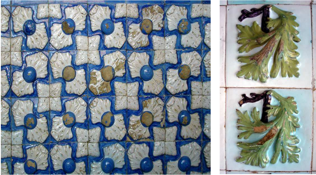
Figura 30- Exemplos de queda do vidro em partes salientes de azulejos cerâmicos do Palácio da Pena em Sintra
