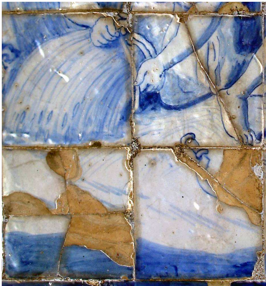
Figura 39- Fragmentação espontânea de azulejos oitocentistas por acção da humidade. Esta degradação, comum nos azulejos históricos, não foi reconhecida na azulejaria de fachada
