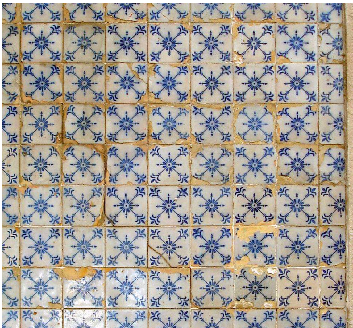
Figura 24- Queda generalizado do vidro a partir das arestas num edifício da Rua das Salgadeiras ao Bairro Alto. A fachada do edifício tinha zonas húmidas, como demonstra o destacamento de azulejos inteiros ilustrado na figura 13a
