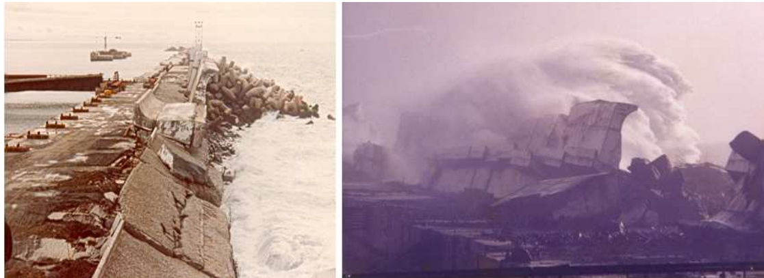
Figura 4: Colapso do manto de protecção e da superestrutura do molhe Oeste do Porto de Sines
