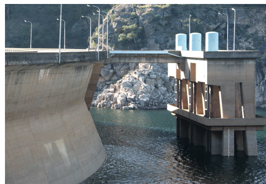
Fig. 4 – Vista lateral da barragem e da torre das tomadas de água com os órgãos de manobra das comportas.
