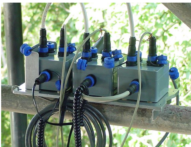
Fig. 9a – Exemplo de fixação das caixas dos sensores sobre a estrutura da cobertura
