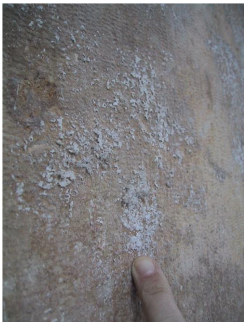
Fig. 5 – Eflorescências – Igreja de Santa Cruz, Coimbra, Fevereiro de 2004.
