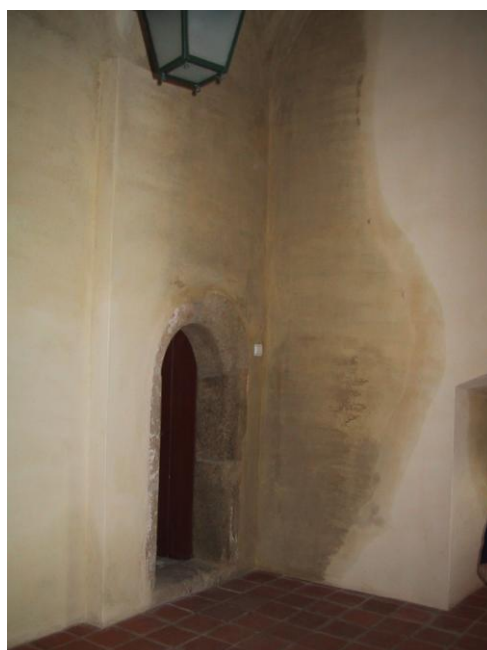
Fig. 8 – Manchas de humidade – Castelo de Terena, Évora, Junho de 2002.
