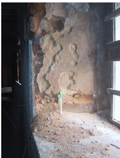
Fig. 7 – Arenização de argamassas – Moinho de Maré dos Paulistas, Corroios, Dezembro de 2004.
