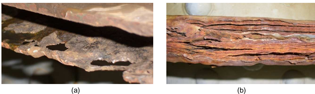
Figura 6. (a) Corrosão uniforme e (b) localizada do tipo intersticial com características selectivas (follheamento) em estruturas de aço
