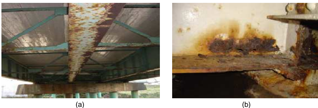
Figura 7. Aceleração da corrosão em zonas microclimáticas na estrutura: (a) zonas de condensação da humidade atmosférica; (b) zonas de retenção de água e detritos.
