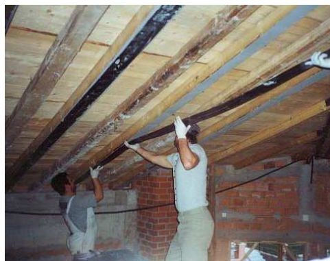
Figura 4: Exemplo de aplicação de FRP numa estrutura de madeira (Catálogo “Sika Carbodur FRP Composites”)
