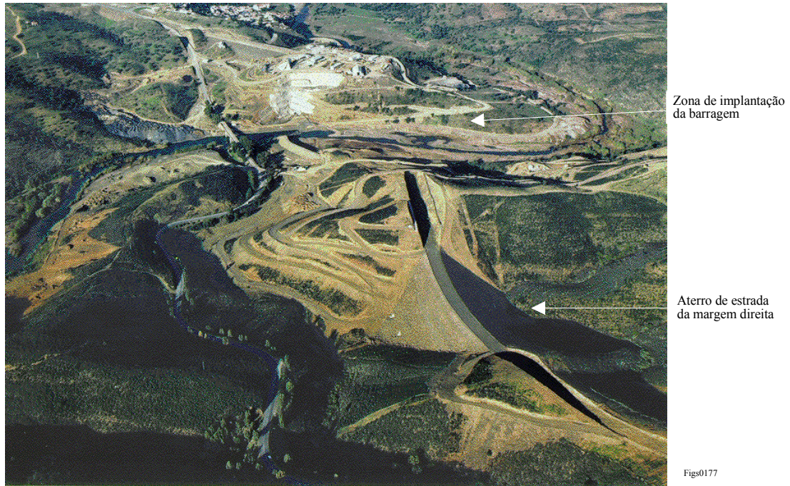
Fig. 5.34 - Fotografia do aterro de estrada e zona de construção da barragem de Odeleite
