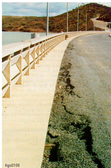
Fig. 3.5 - Fendas longitudinais junto à guarda de montante (Barragem de Beliche)
