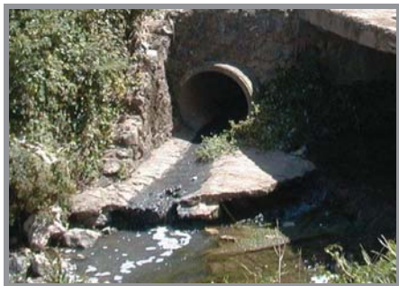
Figura 3.33 – Ligações indevidas (pluvial)
