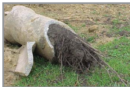
Figura 3.38 – Intrusão de raízes
