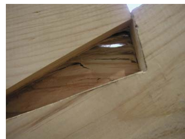
Figura 3.50 - Pormenor (ligação 11.1): rotura da respiga
