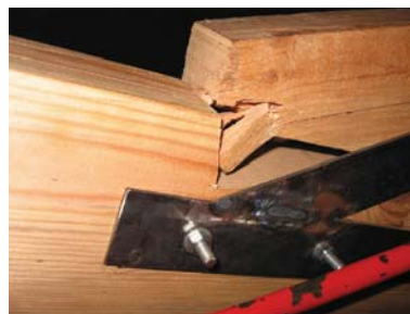
Figura 3.63 - Pormenor (ligação 8.2): rotura do dente
