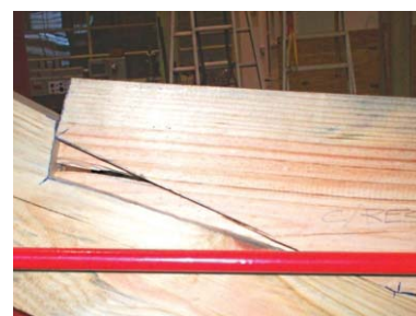
Figura 3.44 - Pormenor (ligação 14.1): rotura da respiga por tracção perpendicular às fibras
