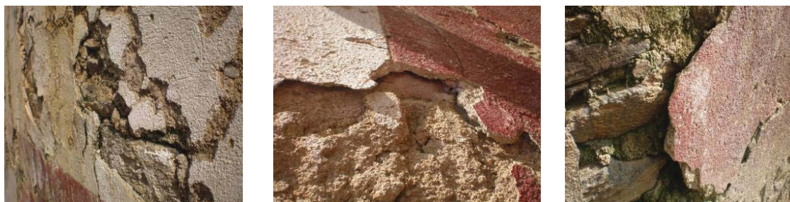
Fig. 371, Revestimento com perda de aderência entre as camadas de reboco e o suporte
