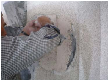
Fig. 211, Preenchimento de uma lacuna com argamassa de restauro (restauro da fachada do Edifício Principal do LNEC)
