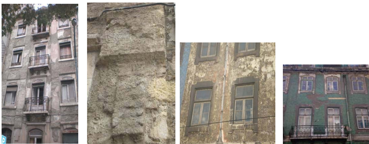
Fig. 198, Diversas formas de contaminações atmosféricas sobre revestimentos na cidade de Lisboa
