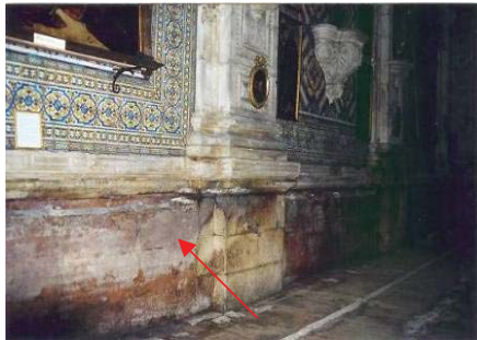
Fig. 26, Sacristia do Mosteiro de Sta. Cruz em Coimbra, nota-se a presença de intensa humidade e uma parede dupla com espaço de ar, para isolar da humidade, sendo esta segunda parede guarnecida por um revestimento de cal e pó de tijolo (esboço) .
