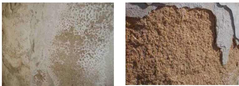
Fig. 194. A perda de coesão nos revestimentos
