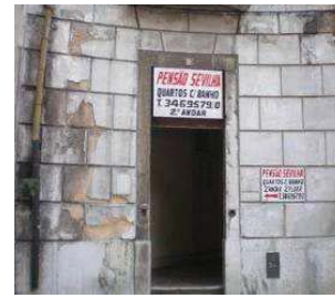
Fig. 63, Destacamento da camada de acabamento do revestimento
