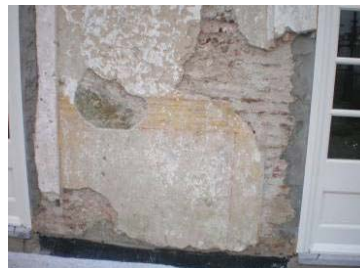
Fig. 215, Lacuna num revestimento decorativo, Edifício do Lidador, Beja
