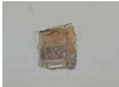
Fig. 170, Descoberta do desenho de uma âncora sobre a alvenaria do edifício, Hospital Miguel Bombarda, Lisboa.
