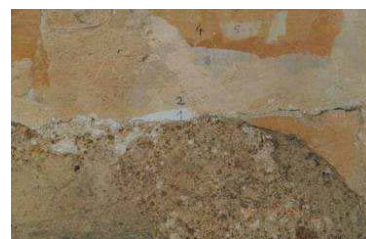
Fig. 178, As diversas camadas de pintura num edifício antigo em Lisboa
