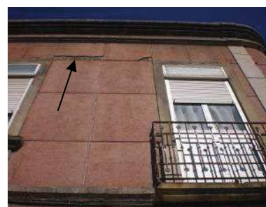
Fig. 83, Acabamento em marmorite vermelha com destacamento, Vila Franca de Xira
