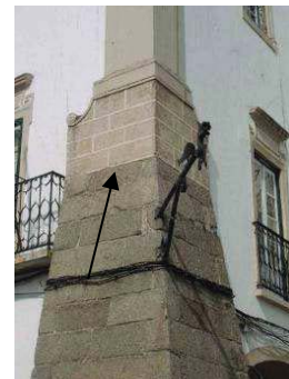
Fig. 54, Acabamento fingido pedra, aplicado por cima da cantaria original embasamento de um edifício na Praça do Giraldo, Évora
