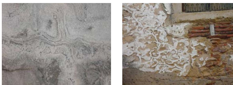
Fig. 195, Erosão presente nos revestimentos
