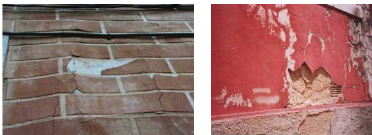
Fig. 193, A perda de aderência em distintos revestimentos
