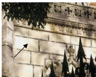
Fig. 72, Pormenor do revestimento alterado, devido às intervenções, Quinta da Regaleira, Sintra
