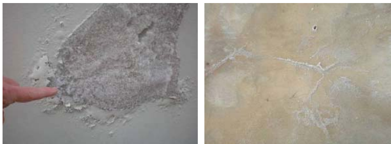
Fig. 192, A presença de eflorescências salinas sobre os revestimentos
