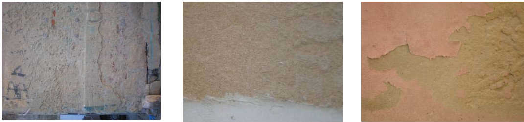
Fig. 228, Argamassas com perda de coesão
