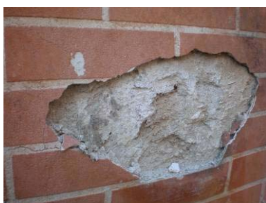
Fig. 99, Lacuna e perda de aderência num revestimento, Sintra
