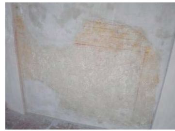
Fig. 216, A mesma lacuna, após obturação com uma argamassa de restauro, Edifício do Lidador, Beja
