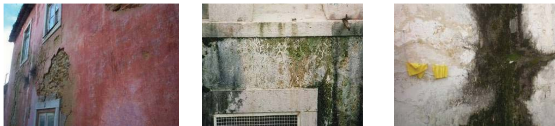
Fig. 191, Humidade presente em diversos revestimentos
