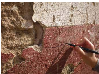
Fig. 374, Identificação da zona com destacamento
