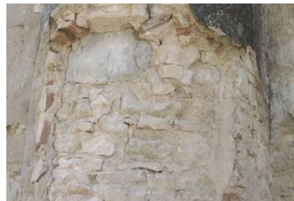
Fig. 172, Cunhal revestido por um barramento com forma arredonda na antiga estrutura do edifício, Hospital Miguel Bombarda, Lisboa.
