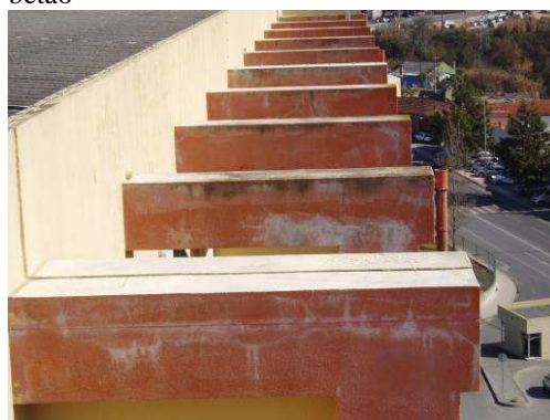
Fig. 19 – Fissuras e eflorescências em reboco exterior
