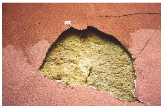
Fig. 23 – Destacamento de reboco de substituição incompatível em parede antiga
