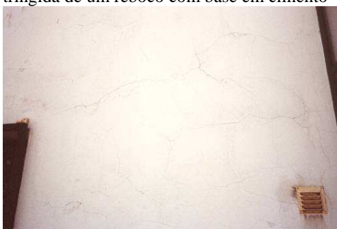
Fig. 12 – Fissuração mapeada por retracção restringida
