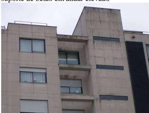
Fig. 18 – Manchas de fungos e de sujidade em reboco exterior
