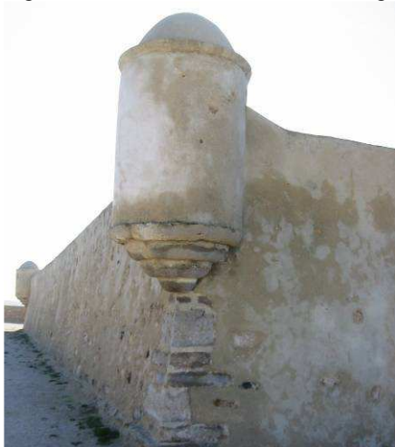
Fig. 26 – Perda de coesão de reboco de substituição devido a sais
