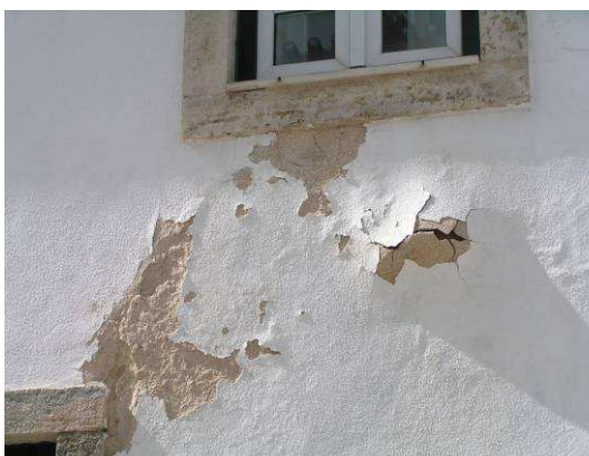
Fig. 22 – Empolamento de reboco de substituição em parede antiga (incompatível?)
