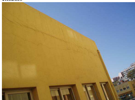
Fig. 15 – Fissuração de reboco na ligação entre a parede de alvenaria, a viga de betão e a platibanda.
