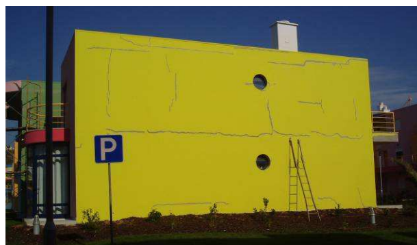
Fig. 11 – Fissuração mapeada por retracção restringida de um reboco de cimento (mais rígido)
