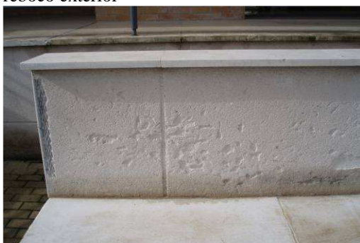
Fig. 20 – Erosão em reboco exterior
