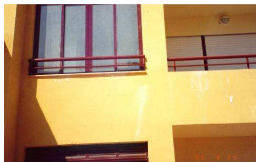
Fig. 21 – Manchas de carbonatação e de sujidade em reboco monocamada
