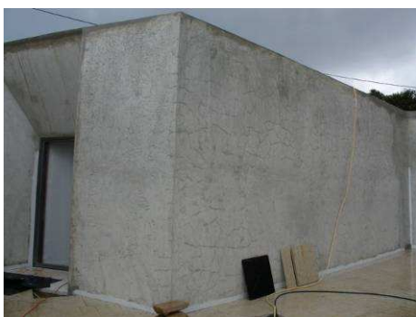
Fig. 10 – Fissuração mapeada por retracção restringida de um reboco com base em cimento
