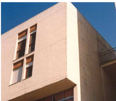
Fig. 14 – Fissuração do reboco devida à fissuração do suporte
