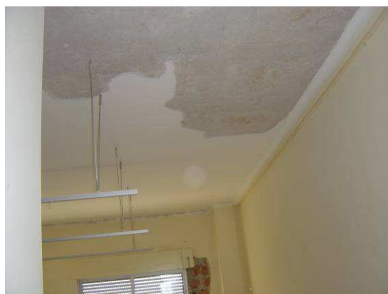
Fig. 17 – Destacamento de estuque de tecto de laje de betão
