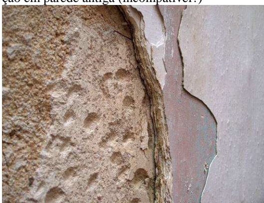
Fig. 24 – Destacamento de reboco antigo
