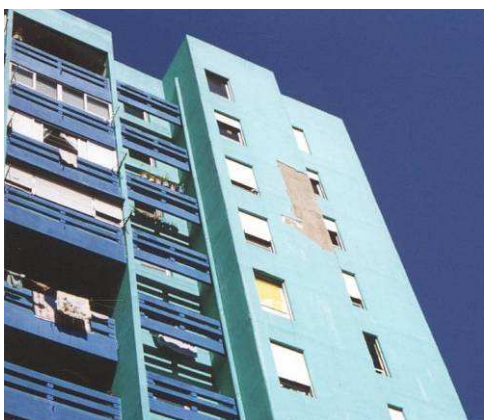
Fig. 16 – Destacamento de porção de reboco de suporte de betão em andar elevado
