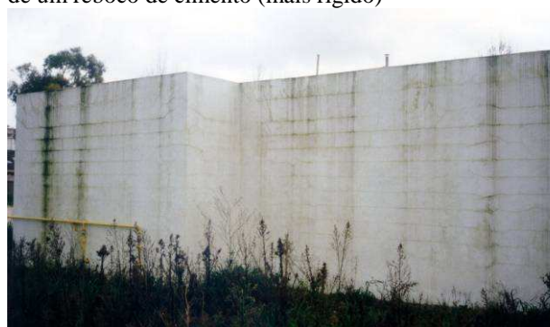
Fig. 13 – Fissuração em correspondência com as juntas de uma alvenaria de blocos de um reboco com base em cimento
